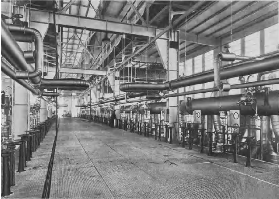
Abb. 11. Halle mit Bedienungsgeräten zur Benzinherstellung.
