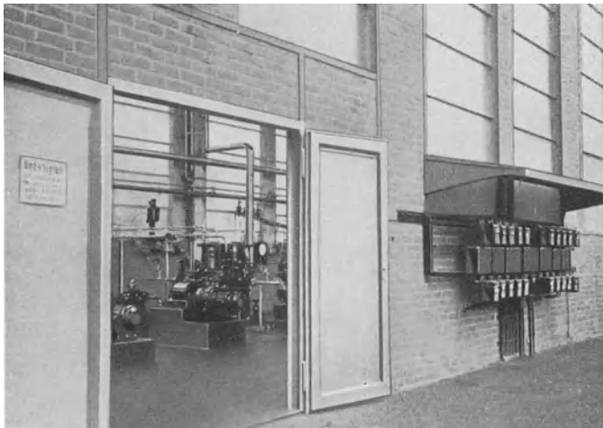
Abb. 82. Niederspannungs-Verteilungsgruppe mit Ölschützen im Freien außerhalb des explosionsgefährdeten Raumes.
