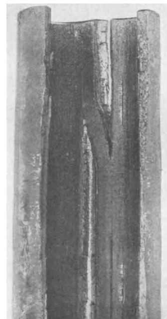
Abb. 9. Fehlstellen im Rohrinne, nahezu durch die ganze Wanddicke reichend.
