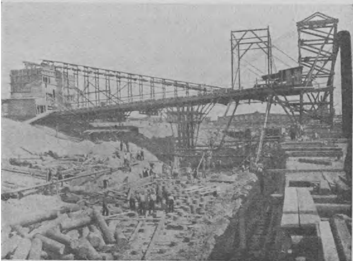
Abb. 8. Ansicht der Betontransportanlage.
