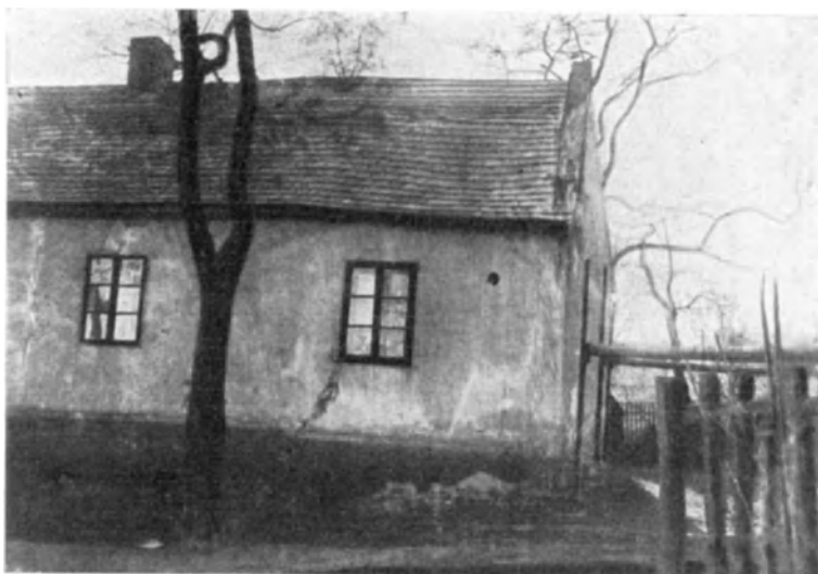
Fig. 174. Bergschäden an einem Gebäude.
