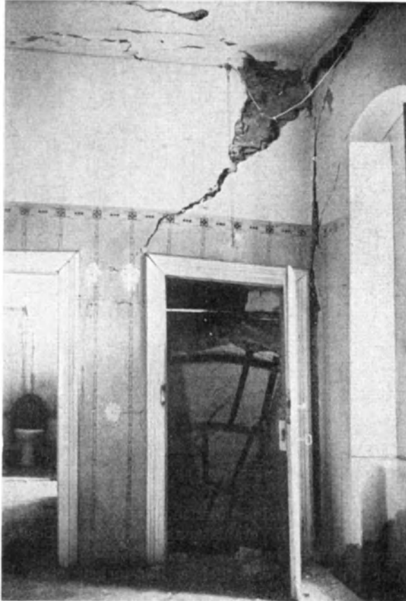
Fig. 177. Bergschäden im Innern eines Gebäudes einer Bergwerksanlage.
