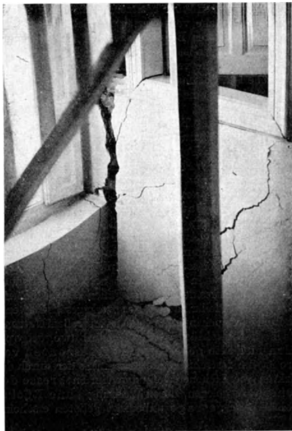
Fig 178. Bergschäden im Innern eines Gebäudes einer Bergwerksanlage.
