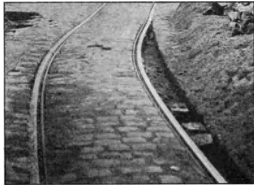
Fig. 149. Gleise im Pressungsgebiet. Das vorhandene Gleis wurde in der Kurve erheblich zur Seite gepreßt, als mit der Auskofferrung für ein zweites Gleis begonnen wurde.
