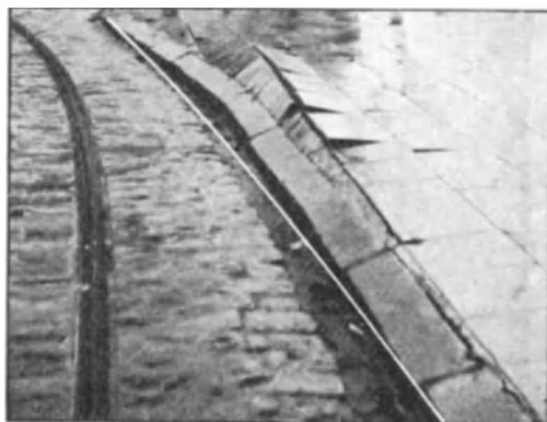
Fig. 151. Gleiskurve S, neugebaut 1907. Erste Pressungserscheinung am 27. März 1909. Zerdrückter Bürgersteig.
