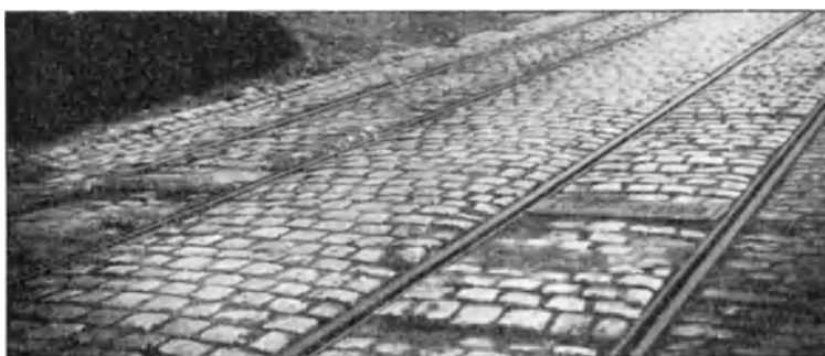
Fig. 147. Beschädigtes Straßenpflaster und verkantete Entwässerungskasten in Altenessen.
