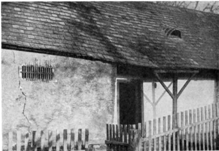
Fig. 176. Bergschäden an einem Gebäude.
