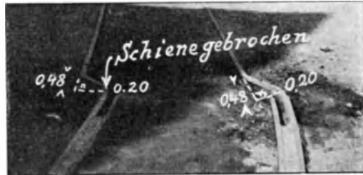
Fig. 139. Durch Pressung seitlich ausgeknicktes Gleis, eine Schiene ist gebrochen. Kraftwerk Borbeck.
