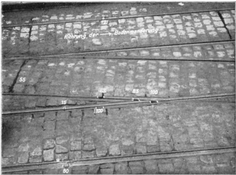
Fig. 163. Infolge Bergbau stark gezeirrter Gleiswechsel mit deutlich erkennbaren Stoßlücken und Pflasterspalten neben den Spurstangen. Herzstücke mußten erneuert werden.
