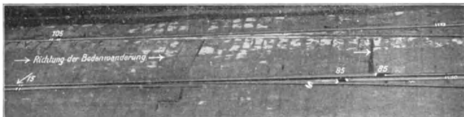
Fig. 164. Infolge Bergbau stark gezerrter Gleiswechsel. Pflasterspalten — in Richtung — der Zerrung hinter Weichenkasten und Spurstangen.
