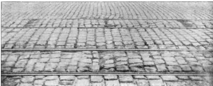
Fig. 135. Beschädigtes Straßenpflaster in Altenessen. Besonders bemerkbar ist die Abweichung der Pflasterfugen vom Gleis.
