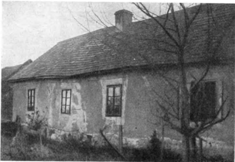
Fig. 173. Bergschäden an einem Gebäude.
