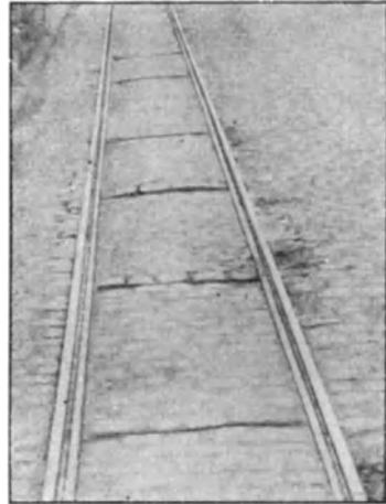
Fig. 134. Durch Pressung beschädigtes Gleis in Altenessen. Die Verwerfung ist aus Fig. 133 ersichtlich.
