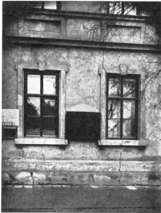
Fig. 198. Teilansicht des Amtsgebäudes der Stadtgemeinde in Breclav (Lundenburg) in der Tschechoslowakei. An fast allen Fenstern des einstockhohen Hauses sind Rißbildungen vorhanden.
