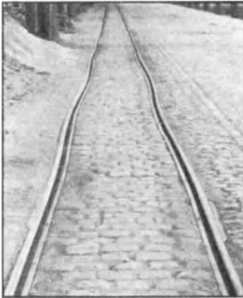
Fig. 132. Durch Pressung schlangenförmig verbogenes Gleis in Altenessen.
