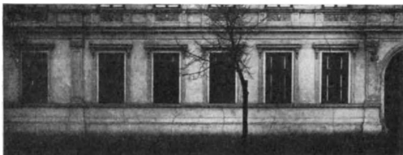
Fig. 200. Gesamtansicht des Erdgeschosses des Beamtenwohnhauses der Kuffnerschen Zuckerfabrik A.-G. in Břeclav, Masarykplatz. Unter sämtlichen Fenstern des Erdgeschosses sind Rißbildungen vorhanden.
