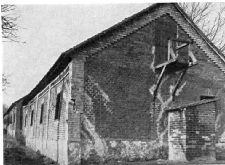
Fig. 175. Bergschäden an einem Gebäude.
