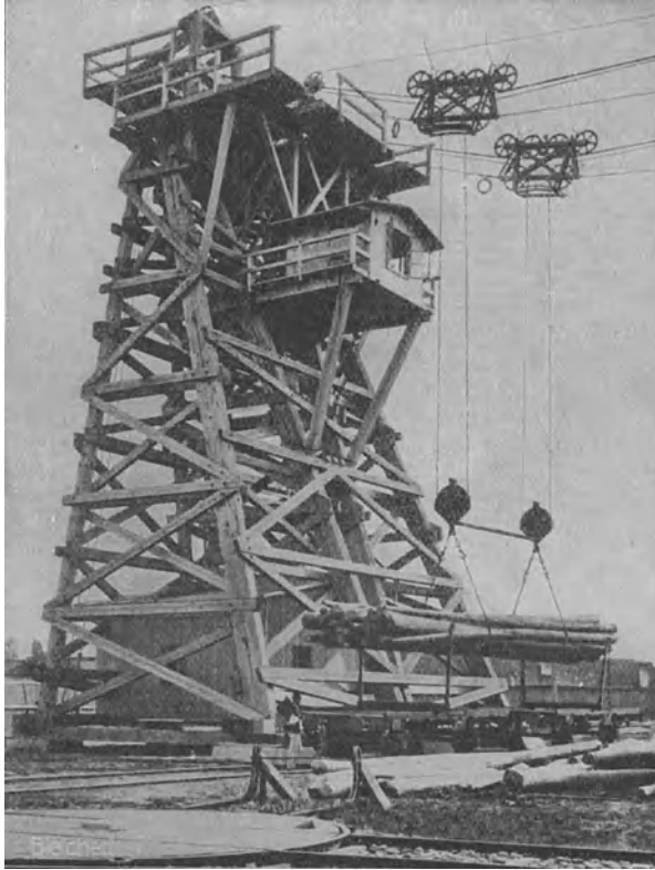
Abb. 317. Maschinenturm eines Kabelkranes in Holzkonstruktion (Doppellaufkatze mit Traverse für Langholz).
