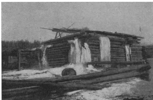
Abb. 14. In Fällen, wo das unterirdisch fließende Wasser im Winter durch die Gefrorenis eingeengt wird, können sog. „ Tarymeisbildungen “ entstehen: unter großem Druck steigt das Wasser in die heizbaren Gebäude und füllt diese mit Eis (aus: W. SCHOSTAKOWITSCH, „ Zeitschr. Ges. f. Erdk. “, Berlin 1927, Nr. 7/8).
