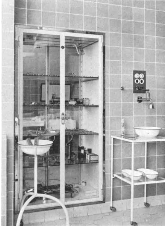
Abb. 70. Instrumentenschrank, im Operationssaal eingebaut.
