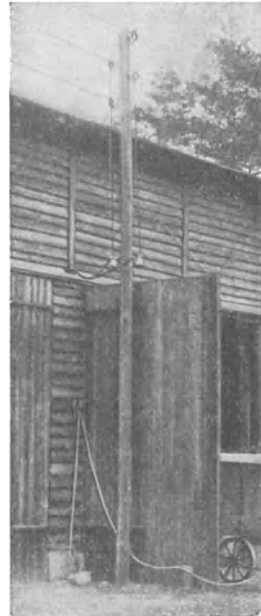
Abb. 10. Vorschriftswidrige Abzweigung der Lichtleitung von der Kraftleitung.
