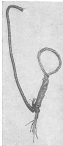
Abb. 19. Liederlicher Anschluß einer Dachständer-einführung.
