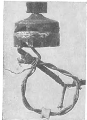
Abb. 22. Vorschriftswidriges Material aus einer Starkstromanlage eines Mühlgelöhfts.
