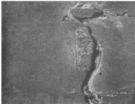
Abb. 61 b. Schweißnaht mit Lunker, freigelegt.
