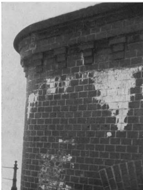
Abb. 55. Kalkausblühungen. Aus dem sehr stark kalkhaltigen Mörtel hat sich Kalk als doppeltkohlen-saurer Kalk gelöst und als harte weiße Schicht wieder abgeschieden.
