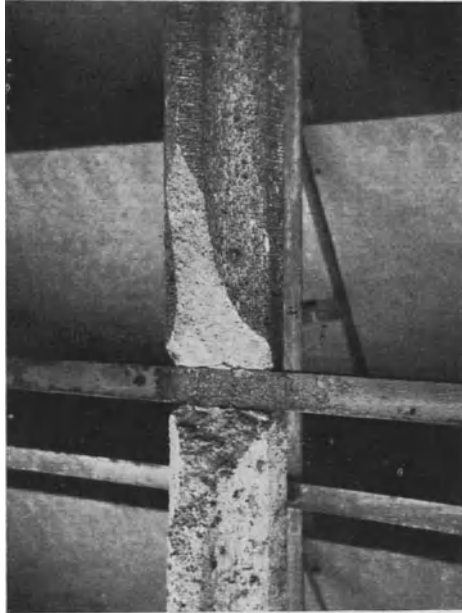
Abb. 15. Zerstörungserscheinungen durch Rosten eingebetteter Eisen als Sprossen: In den Naturstein eines Kirchturmfensters in Köln eingebettete Eisen rosten und zersprengen den Stein.
