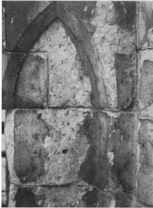
Abb. 11. Verwitterung durch Salzbildung (Kölner Dom): Das auskristallisierte Salz zersprengt den Stein. Die Auskristallisation tritt ein, wo starke Verdunstung stattfindet, also auch an geschützten Stellen, weil hier das schädliche Salz nicht ausgewaschen wird. Vom Regen getroffene Stellen blieben ohne
