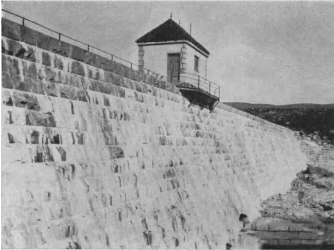
Abb. 31. In Zerstörung begriffene norwegische Talsperre: Das sehr weiche kohlensäurereiche Wasser zermürbt den Beton. Die starken Kalkausscheidungen weisen auf diese noch nicht in Erscheinung getretene Zermürbung hin (Bild Rolfsen).
