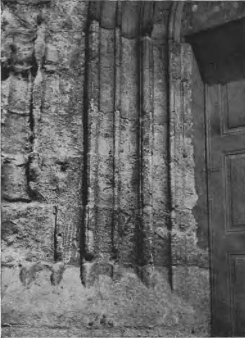
Abb. 14. Verwitterung durch Lösungserscheinungen. Das Bindemittel des Sandsteins ist gelöst, der Sand des Sandsteins rieselt herab. Die Lösung tritt nur da ein, wo der Regen einwirken kann, an den geschützten Stellen oben im Torbogen keine Verwitterung.
