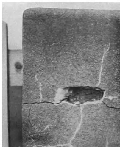
Abb. 53. Gemauerter, mit Putz umkleideter Gartenpfeiler, zerstört durch einen einzigen ungenügend stark gebrannten Ziegelstein.
