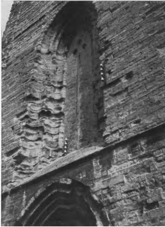
Abb. 10. Verwitterungserscheinungen an einer Soester Kirche: Sandstein ist verhältnismäßig porös und die einzelnen Quarzkörner durch ein wenig widerstandsfähiges Bindemittel verbunden. Das Bindemittel wird durch das Wasser gelöst, der Sand rieselt herab.
