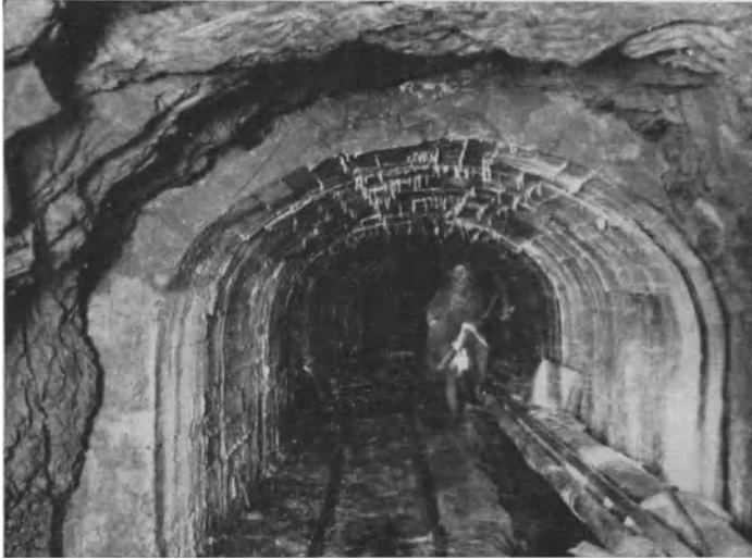
Abb. 12. Stalaktitenbildung in einem Betontunnel: Das Wasser mit einem hohen Gehalt an aggressiver Kohlensäure hat den Kalk des Betons als kohlensauren Kalk gelöst. Aus der Lösung schied sich wieder kohlensaurer Kalk unter Entweichung von Kohlensäure ab.
