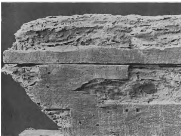
Abb. 60. Beispiel einer Zerstörung durch Holzbock: Der Holzbock zerfrißt das Holz. Er tritt in letzter Zeit in steigendem Maße auf. Da die Oberfläche zunächst intakt bleibt, werden leicht Zerstörungen bei Festigkeitsuntersuchungen erst später entdeckt 1 . Abhilfe ist nur möglich durch Vergiftung des Holzes.
