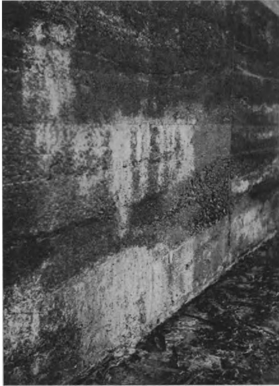
Abb. 30. Kalkausscheidung an einem mit starken waagerechten Arbeitsfugen errichteten Bauwerk. Der Kalk wurde vom Wasser, das von oben eindrang, aus dem Beton gelöst und schied sich auf der Oberfläche aus dem an den Arbeitsfugen austretenden „Kalk“wasser ab.
