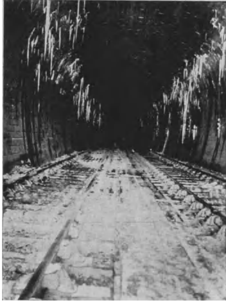
Abb. 37. Beispiel einer Schwefelsäurezerstörung: Die schweflige Säure der Rauchgase hat den Mörtel unter Gipsbildung gelöst. Das Bild wurde aufgenommen bei Frost. Das Wasser aus dem Gebirge über dem Tunnel ist durch die zerstörten Fugen hindurchgetreten, zu Eiszapfen gefroren und zeigt so die undichten Stellen, die sich da bildeten, wo die Lokomotivgase gegen die Decke geblasen wurden. (Bild Wolfsholz.)
