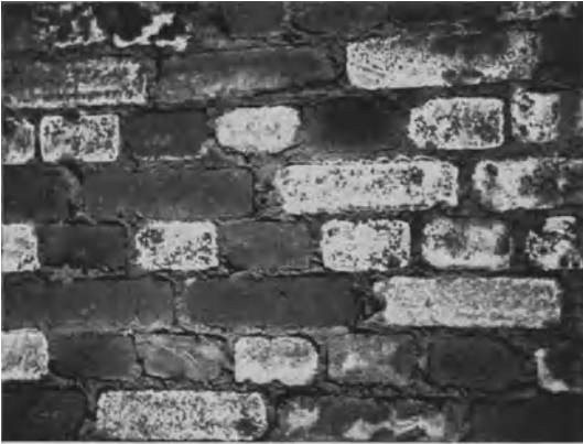
Abb. 52. Ausblühungen an Ziegelmauerwerk. Die Ausblühungen sind entstanden durch Sulfat, welches mit dem Kalk des Mörtels Gips bildet. Diese Ausblühungen sind schwer abwaschbar.
