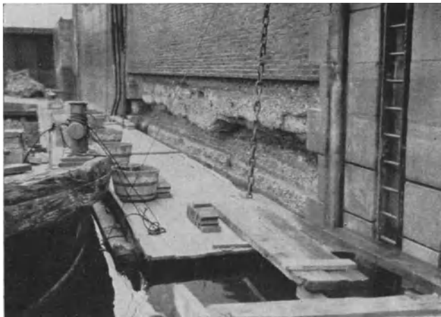
Abb. 46. Zerstörung von Beton hinter Ziegelsteinverblendung in einer Schleuse durch Meerwasser. Die Verblendung hält naturgemäß auf längere Zeit nicht dicht. Der Beton war mit Rücksicht auf die Verblendung fälschlicherweise porös hergestellt und wurde durch das Sulfat zum Treiben gebracht. Die Raumvergrößerung führte zu Aufbauchung des Mauerwerks. Die Zerstörung des Betons wurde also durch die Verblendung nicht verhindert, sondern nur verborgen. Man arbeitet deshalb heutzutage ohne Verblendung.
