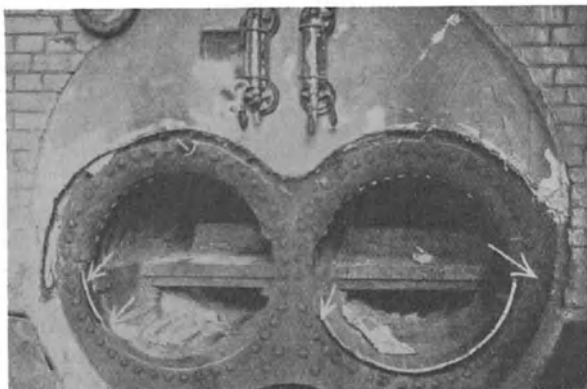
Abb. 180. Risse an Flammrohren.
