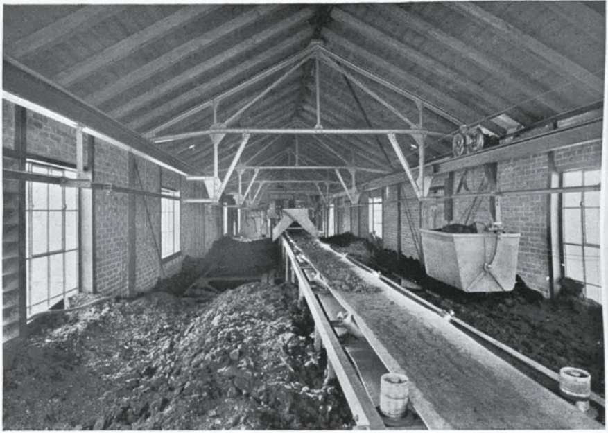
Kraftwerk Hirschfelde, Kohlentransportband
