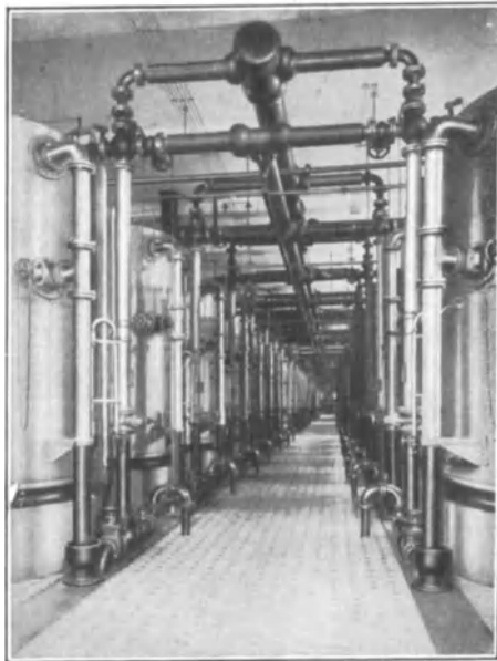
Abb. 8. Größte Permutitanlage in einem deutschen Kraftwerk.
