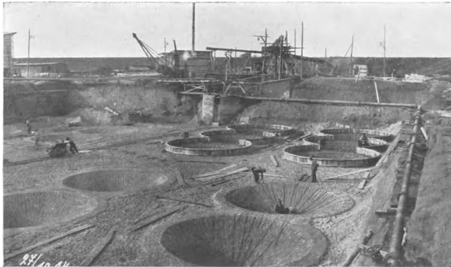
Abb. 543. Baugrube für den Bau der Emscherbrunnen in Meiderich-Hamborn am Rhein. Das Grundwasser wird mit der rechts sichtbaren Rohrbrunnenanlage abgesenkt.
