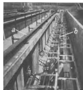
Abb. 569. Rührwerk und Preßluftleitung in einem Schlammbelebungsbecken. a Preßluftzuführung, b Rührwerk. (K. Imhoff, Essen)
