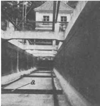
Abb. 571. Leeres Absitzbecken mit Kratzerband in Werden. a Kratzer. (K. Imhoff, Essen)
