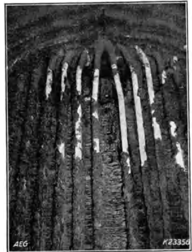
Abb. 246. Werk I. Aschenansätze auf den Rückwandkühlrohren und Zerstörung der Mauerstreifen zwischen den Kühlrohren des Kessels in Abb. 243, links.
