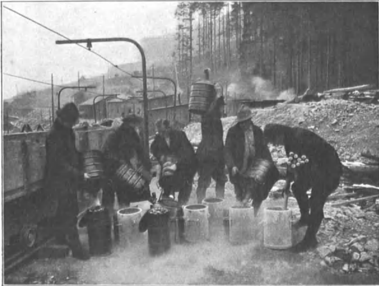
Abb. 98. Tränken der Patronen für Sprengungen mit flüssiger Luft. Mit Genehmigung der Siemens-Bauunion, Forbach in Baden.
