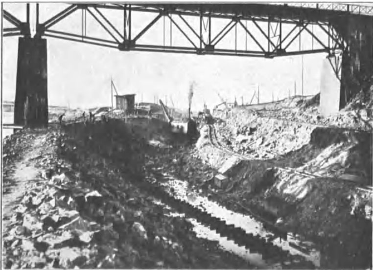
Abb. 102. Schleusenrinne, Baustelle Donau-Kachlet bei Passau der Bayerischen Bauindustrie A.-G. Am linken Stoß wird nach dem Sprengluftverfahren geschossen (Sprengluftanlage Bauart Linde, Leistung 20 kg/st).
