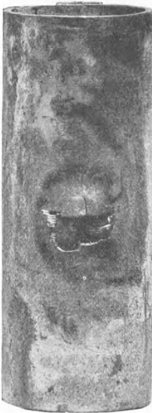
Fig. 52. Abschnitt eines ausgebeulten und lecken Wasserrohres.
