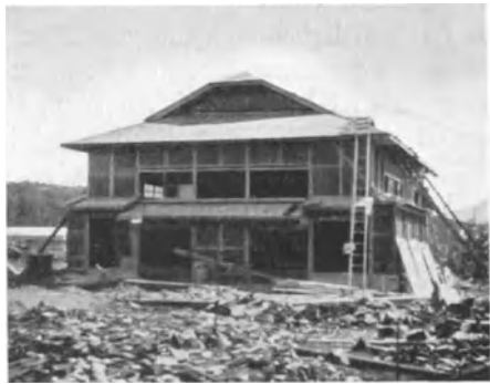
Abb. 14. Großes Tango-Beben (Japan) vom 7. März 1927. Haus mit leichtem Dach in Mineyama, in fast vollständig zerstörter Umgebung nur leicht beschädigt. Nach T. Taniguchi.
