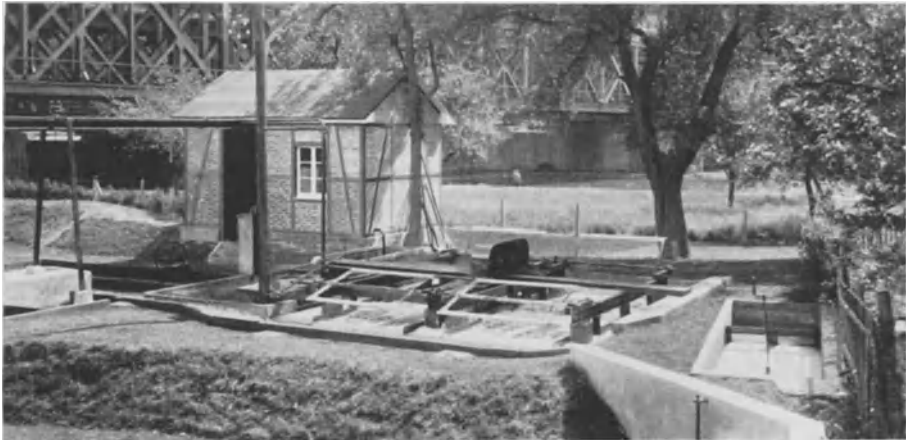
Abb. 41. Wollfettgewinnungsanlage mit Hilfe belüfteter Tauchkörper (Kläranlage Kettwig des Ruhrverbandes).
