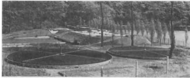
Abb. 128. In den Boden eingelassener Tropfkörper der Kläranlage Neviges.
