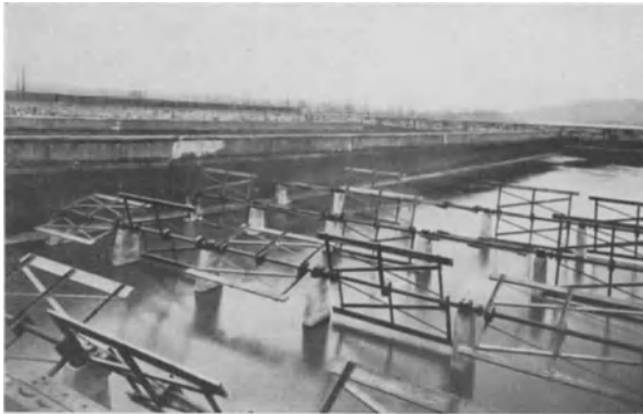
Abb. 52. Reaktionsbecken mit eingebauten Rührwerken (Flocculator).
