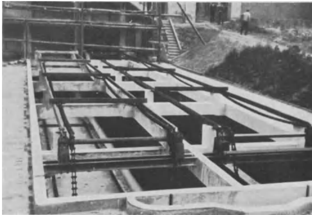
Abb. 65. Langgestrecktes Absetzbecken mit über Wasser zurücklaufendem Kratzerband (Kläranlage Werden).
