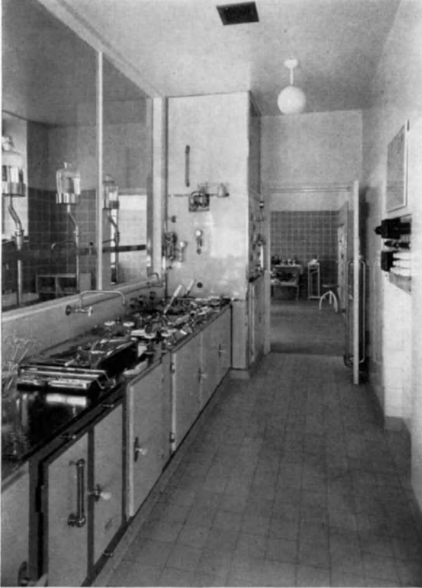
Abb. 31. Instrumentensterilisationsraum der Poliklinik mit Durchblick geradeaus in den aseptischen Operationsraum, nach links in den Händewaschraum.
