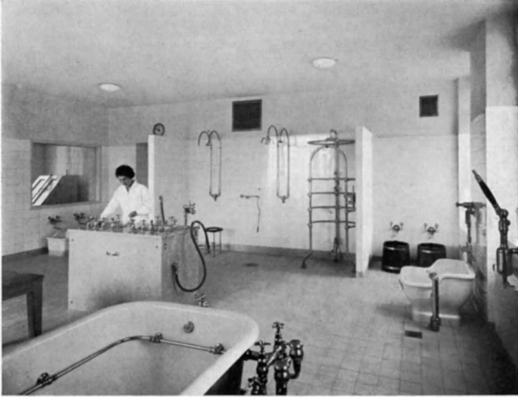
Abb. 33. Großer Heilbäderraum (Kneippische Duschen, Unterwassermassage, Schwitzbäder u. a.).
