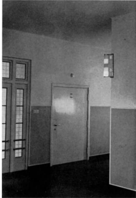
Abb. 26. Lichtsignaltafel der Krankenrufanlage kombiniert mit Leuchtzeichen der Personensuchanlage an einer Wandkante der Krankenabteilung; Sicht von vielen Blickrichtungen aus moglich.
