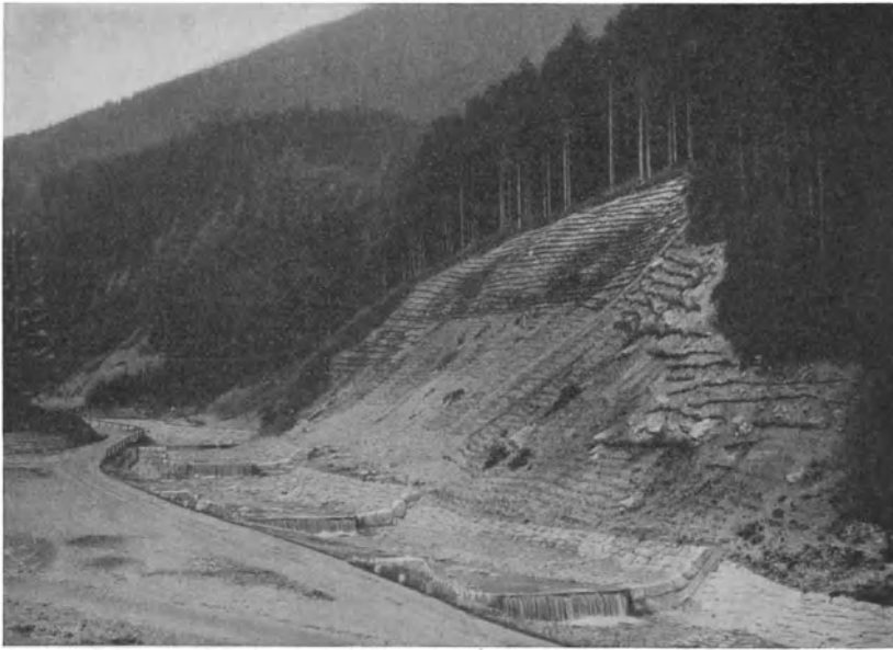
Abb. 4. Langbathbach bei Ebensee, Oberösterreich; durch Grundschwellen und Leitwerke gesicherte Bachstrecke, Lehnenbindung begonnen.*
