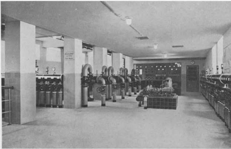
Abb. 71. Wärmezentrale der in der Abb. 68 dargestellten Großbadeanstalt.
