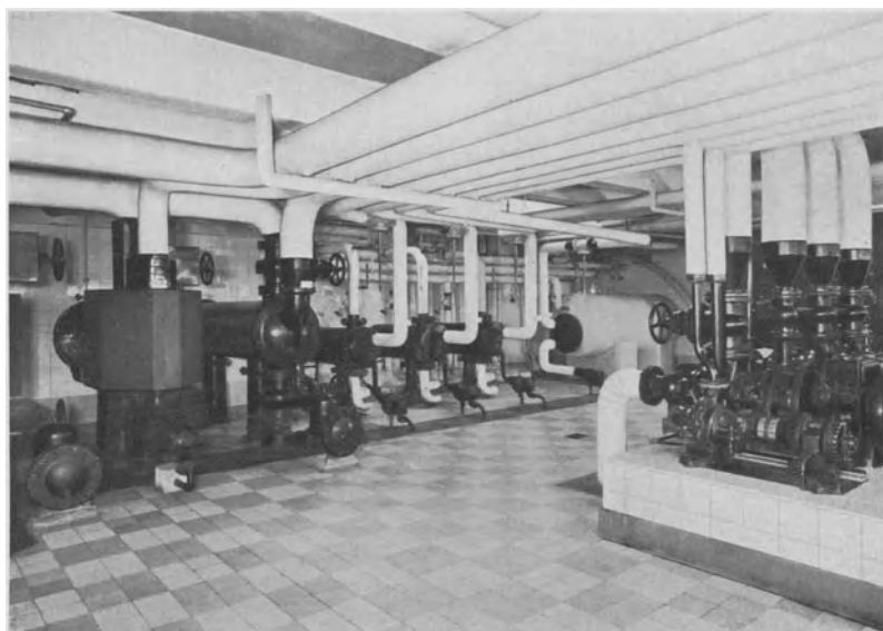
Abb. 51. Gegenstromapparate für die Heizung und Warmwasserbereitung des Verwaltungsgebäudes einer Allgemeinen Ortskrankenkasse.
