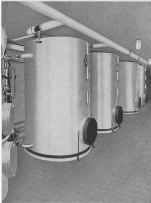
Abb. 13. Ansicht einer Elektro-Heißwasserspeicheranlage, bestehend aus 4 Speichern je 2000 l.
