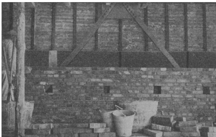
Abb. 8. Beispiel für die Isolierung eines ganzen Giebels gegen den Nachbar hin, zur Vermeidung von Schwingungsübertragung. Der sichtbare eiserne Verband gehört zum Neubau.
