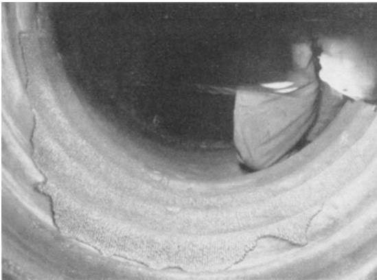
Abb. 228. Verschweißte Korrosionen an einem Kesselflamrohr.
