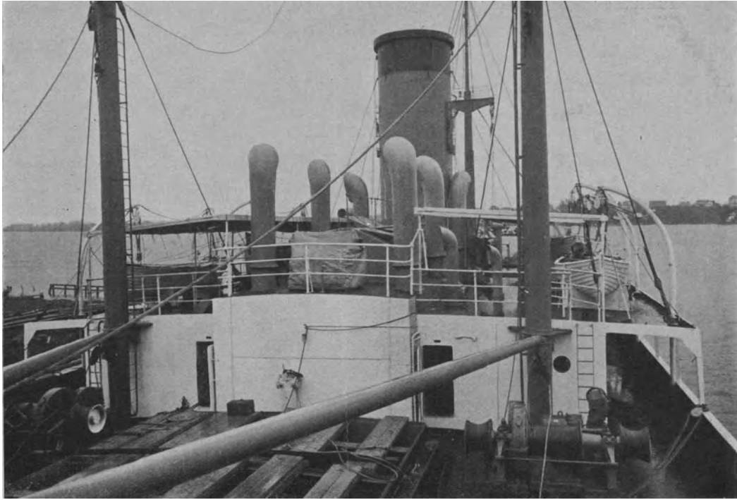
Abb. 18. Anordnung von Ladewinden mit Schützensteuerung auf Deck.
