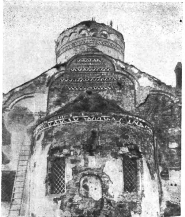
68. Новгород. Церковь Дмитрия Солунского после разрушения
