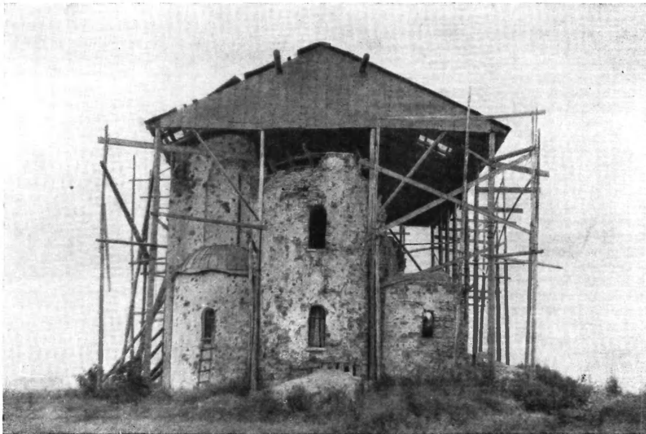
113. Новгород. Руины церкви Спаса на Нередице. Устройство временных навесов над памятником в целях предотвращения дальнейшего его разрушения от атмосферных осадков
