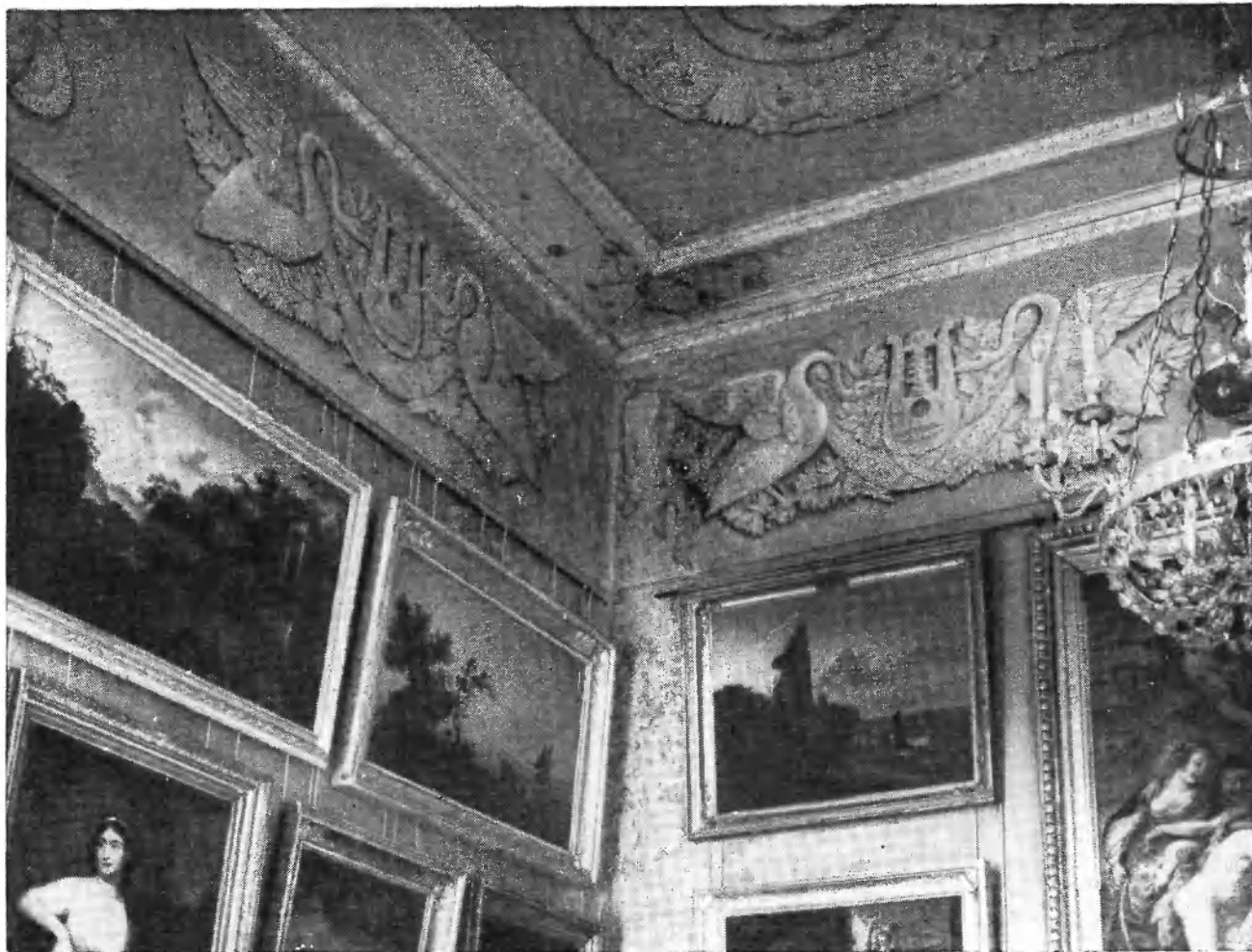
185. Появление ржавых пятен в углах потолка из-за неисправности кровли во дворце-музее в Архангельском под Москвой
