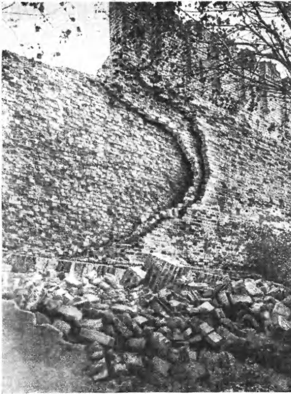
27. Смоленск. Крепостные стены. Послойная деформация от заморзания влаги
