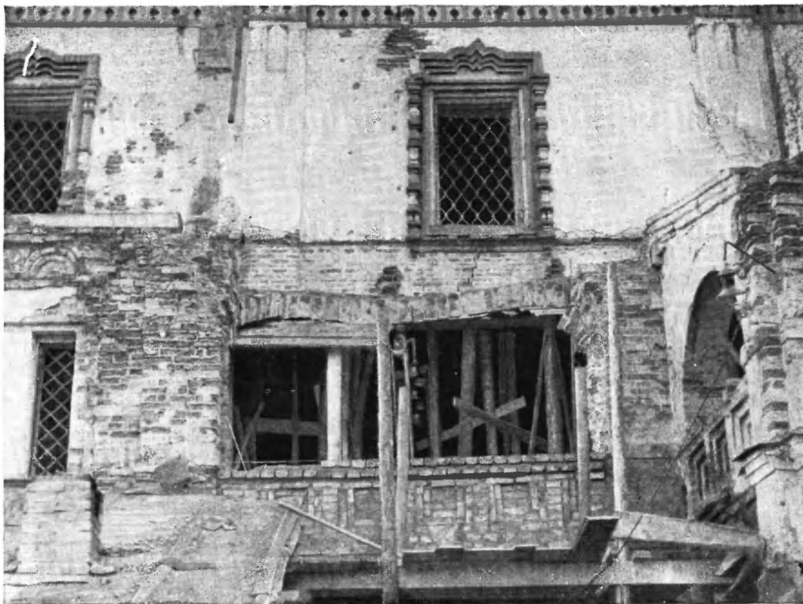
111. Новгород. Знаменский собор. Укрепление сводов и перемычек памятника временными деревянными стойками и подкосами
