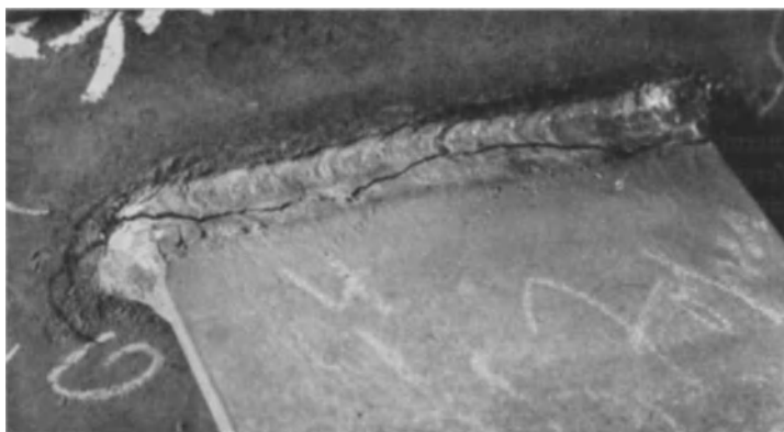
Bild 36. Bruchriß im Anschluß eines Querträgers an den Hauptträger, oftmals hervorgerufen durch wiederholte Belastung.
