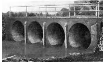
Abb. 32. Durchlaß aus Wellblechröhren großen Durchmessers (über 2 m) als Ersatz für eine Brücke [D 33].
