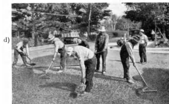
Abb. 130. Herstellung von Teermischmakadam. b) Aufbringen der Binderlage auf vorhandenem Unterbau, c) Abwalzen der Binderschicht, d) Ausbreiten der Decklage.
