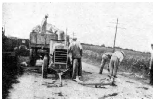
Abb. 180. Anheben einer abgesunkenen Betondecke durch Einpumpen einer dünnflüssigen Mischung von Sand, Wasser und Zement [C 110].
