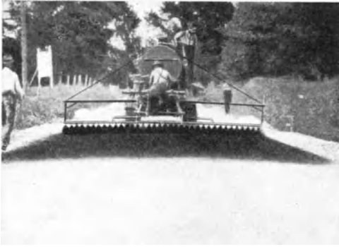
Abb. 98b. Sprengstreifen über die ganze Straßenbreite [D 39].
