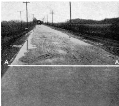
Abb. 190. Bedeutung einer guten Entwässerung des Planums (vorderer Teil des Bildes) und des Fehlens einer solchen (hinterer Teil des Bildes) für die Lage und Haltbarkeit einer Klinkerdecke [D 98].
