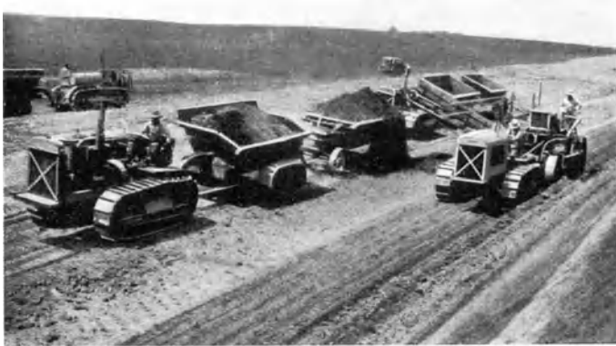
Abb. 54. Neuzzeitliches Verfahren zur Herrichtung des Straßenplanums mit Maschinen [C 139]. (Rechts Fördermaschine mit Gurtband (elevating grader), im Vordergrund Traktor mit Transportwagen (dump wagon) beim Füllen, dahinter zweiter Traktorenzug zum Nachrücken).
