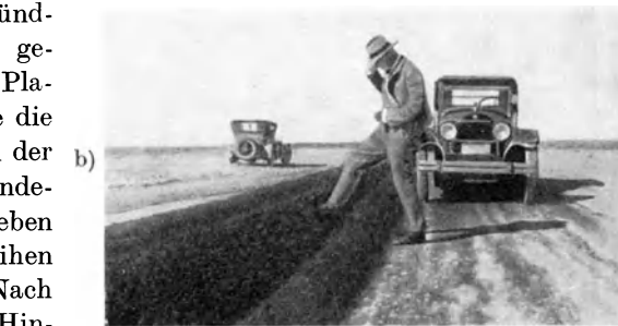
Abb. 80. Oberflächenvermischung einer Kleinschlagdecke in den Weststaaten [C 79]. a) Auflockern einer alten Decke mit Scheibenegge und Zahnegge, b) Anhäufung des Mischgutes in Längsreihen.
