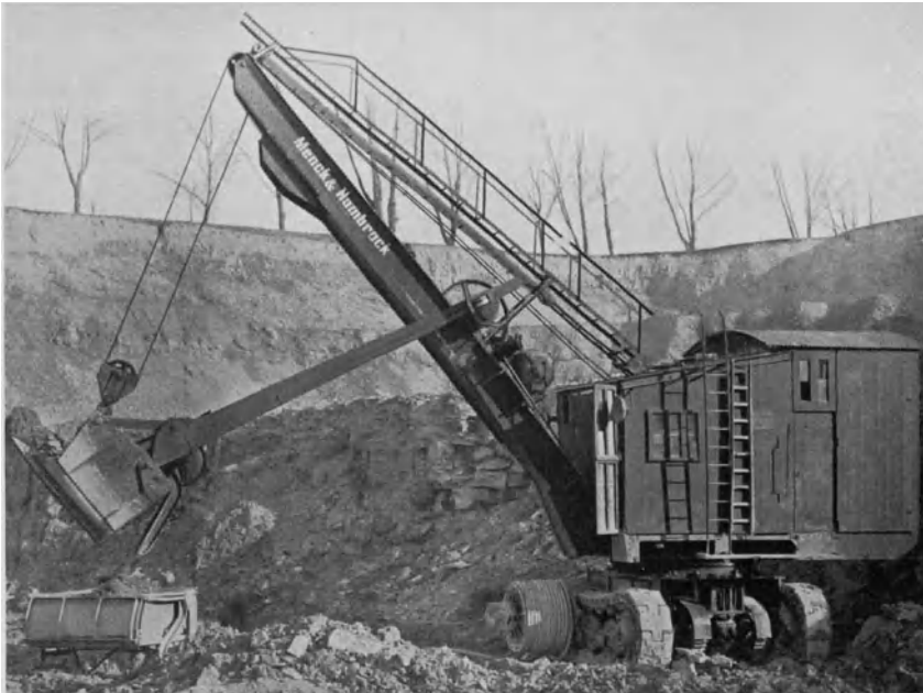
Abb. 164. Stromzuführung mittels Schleppkabel über Kabeltrommel zu einem Löffelbagger (Menck & Hambrock). Gekapselter Vorschubmotor am Ausleger.
