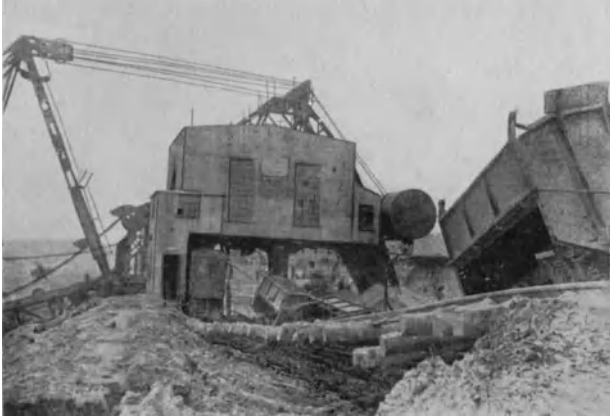
Abb. 255. Rutschungen in der Baggerböschung.
