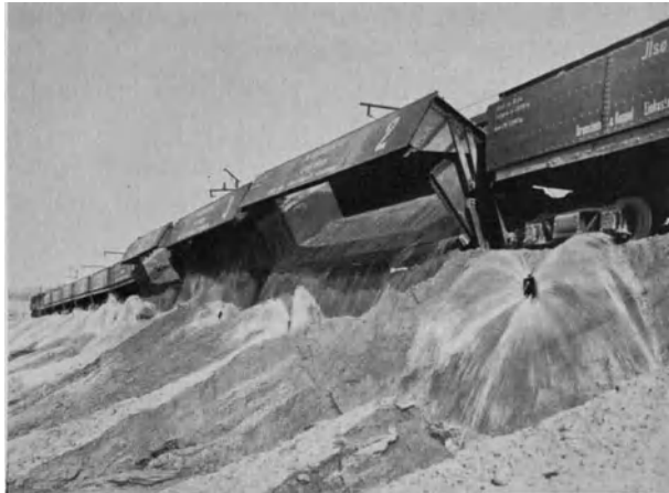
Abb. 688. Spülkippe mit Großbraumwagen und Wasserverteilung.
