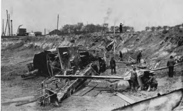
Abb. 213. Löffelbagger auf Schienen im Mergelboden, infolge Gegenwart von Wasser versackt.
