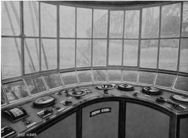
Abb. 817. Zentralsteuerpult der Brücke „Roberts Hoffnung“. (BBC-Nachrichten.)
