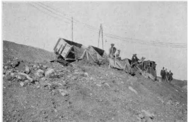
Abb. 697. Mangelhafte Entleerung eines Kastenkipperzuges.
