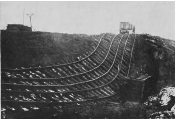
Abb. 256. Rutschungen in der Baggerböschung.
