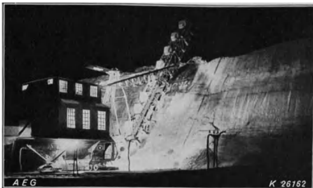
Abb. 377. Anstrahlen der Böschung durch Flutlichtbeleuchtung am Fahrgestell der Baggers (AEG).
