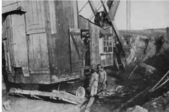
Abb. 235. Betriebsbeanspruchungen von Löffelbagger-Gleisrosten (Menck & Hambrock).
