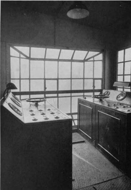
Abb. 374. Führerstand eines neuen elektrisch betriebenen Baggers mit Fernsteuerschalter (SSW).
