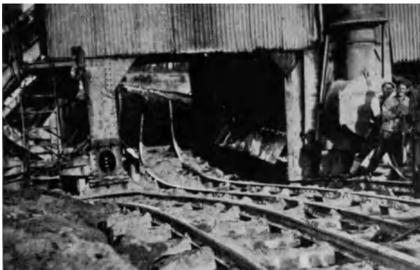
Abb. 253. Rutschungen in der Baggerböschung.
