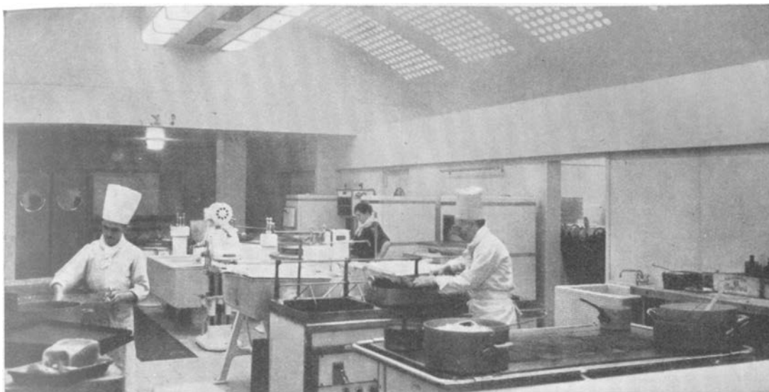
Cuisine du réfectoire du personnel de la Compagnie Parisienne de Distribution d'Electricité. Tous les appareils fonctionnent à l'électricité : on voit le fourneau, les friteuses, les bacs mélangeurs, les fours, une salamandre. (Phot. C.P.D.E.)
