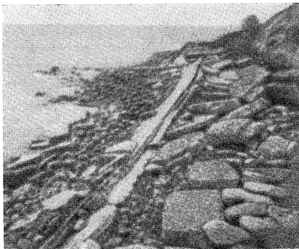
Рис. 254. Защитная стена на берегу Балтийского моря на острове Узедом, разрушенная при урагане в декабре-январе 1913—1914 гг.
