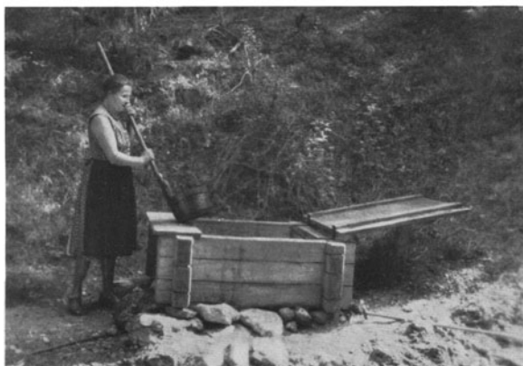
Abb. 124. Fassung einer Schichtquelle an der Grenze zwischen Moräne (im Liegenden) und Eiszeitschottern (im Hangenden) durch einen Schacht auf der Straße von Rükersdorf nach Sonneck, Kärnten. Aufnahme Stiny 1932.
