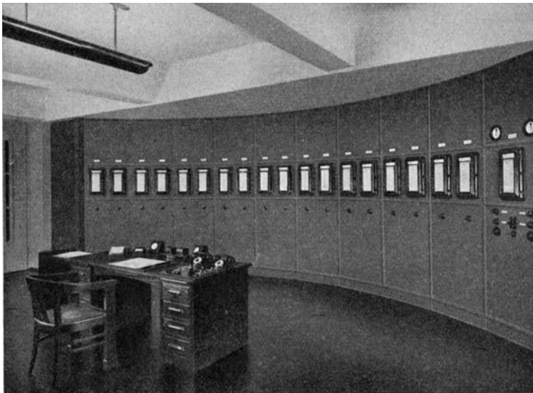
Abb. 32. Wärmewarte eines Ferngasnetzes. Mit den Schreibgeräten werden Druck, Temperatur und Heizwert des Ferngases aufgezeichnet. Die zugehörigen Meßstellen befinden sich in den Bezirken, aus denen das Ferngas geliefert wird. Die Meßstellen für Menge und Heizwert liegen in den Kokereien, während die Druckmeßstellen auf das Gasleitungsnetz verteilt sind.
