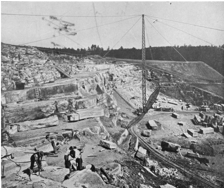
Abb. 411. Derik-Anlage und Kleinbahn in den Marmorsteinbrüchen der Marmorwerke W. Thust, Groß-Kunzendorf, Kreis Nelsse
