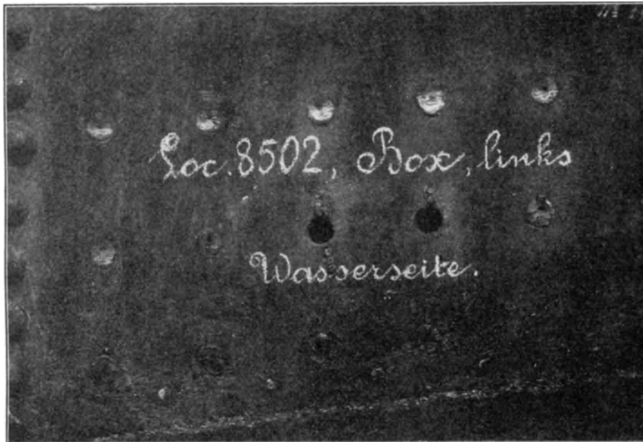
Abb. 73. Verbohrte und verschraubte Risse in einer Feuerbüchsmantelplatte aus Flußstahl.
