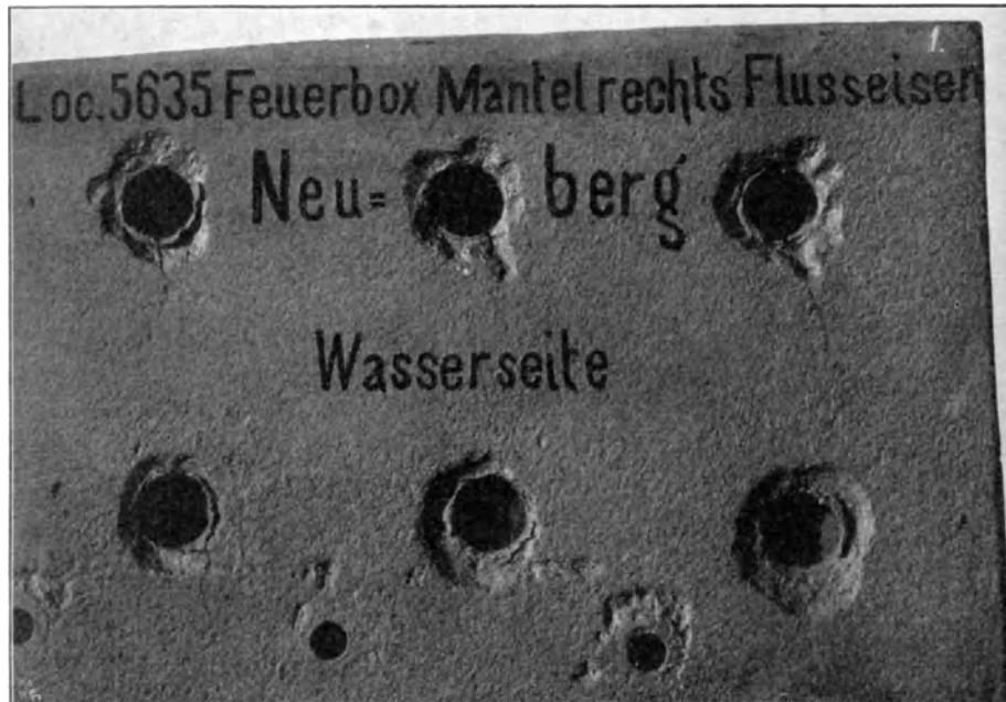
Abb. 62. Wasserseitig korrodierte Seitenwand einer flußeisernen Feuerbüchse.
