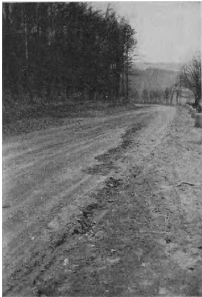
Abb. 58. Gefährdung eines Straßenkörpers durch Böschungsrutsch.
