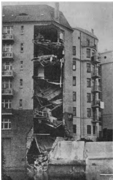
Abb. 90. Hauseinsturz in Hamburg.
