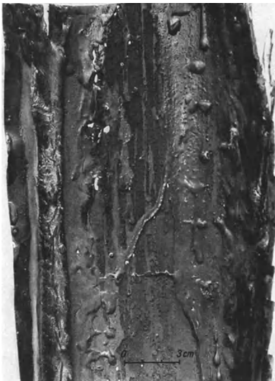
Bild 4. Regenabfallrohr Bremerhaven Innenwand (c) des durchlöchernten Rohres Rückseite des Abschnittes b
