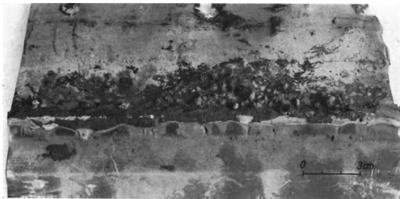
Bild 6. Vorstoßblech Frankfurt a. M. Im Zustand der Einlieferung
