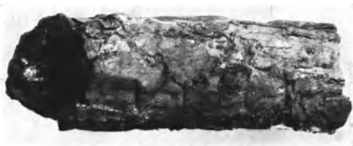
Bild 2. Heizungsrohr nach 5 Jahren in feuchtem Steinholz
