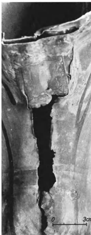
Bild 5. Regenabfallrohr Ober-Thiemendorf Beschädigtes Kniestück mit Flickstelle
