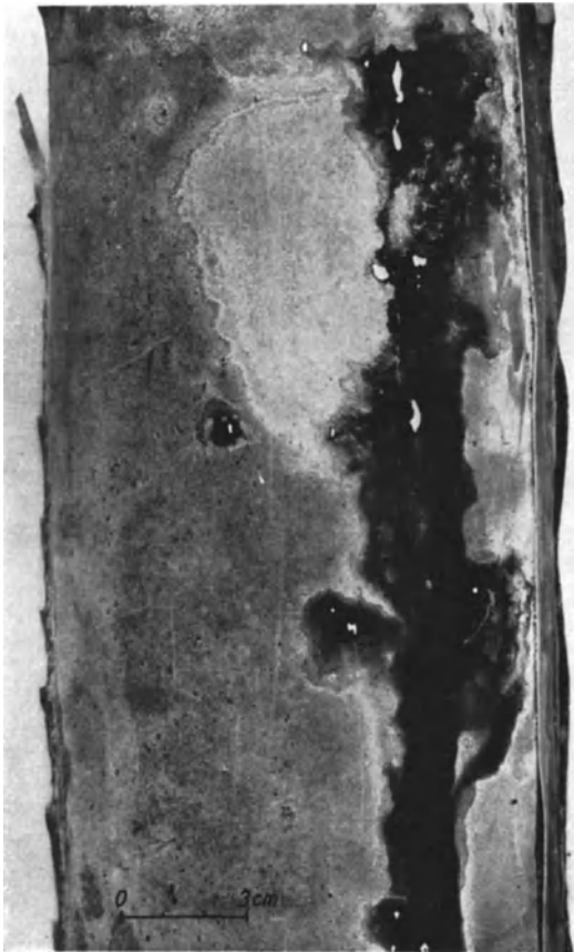
Bild 3. Regenabfallrohr Bremerhaven Außenseite des durchlöchernten Rohres nach Wegnahme des übergelöteten Zinkblechstreifens (b) (Der Fläche (a) gegenüberliegend)
