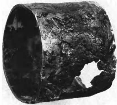
Bild 1. Bleirohr nach 3 Jahren in feuchtem Kalkmörtel
