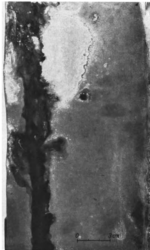
Bild 2. Regenabfallrohr Bremerhaven Innenseite des übergelöteten Zinkblechstreifens (a)
