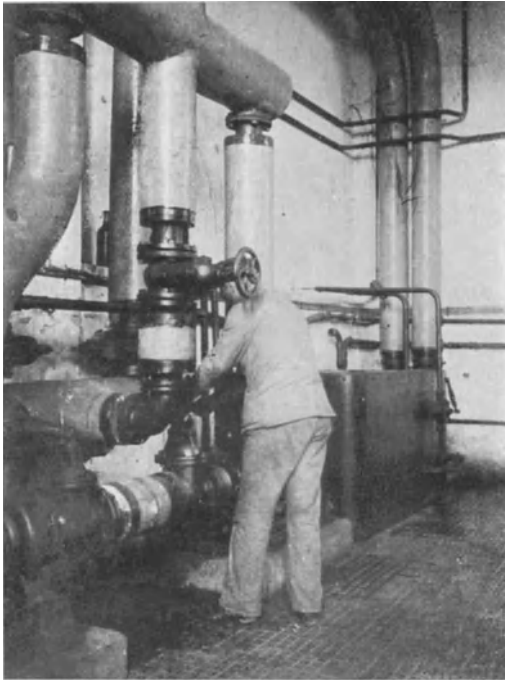
Das Kesselhaus der Zentralheizung.
