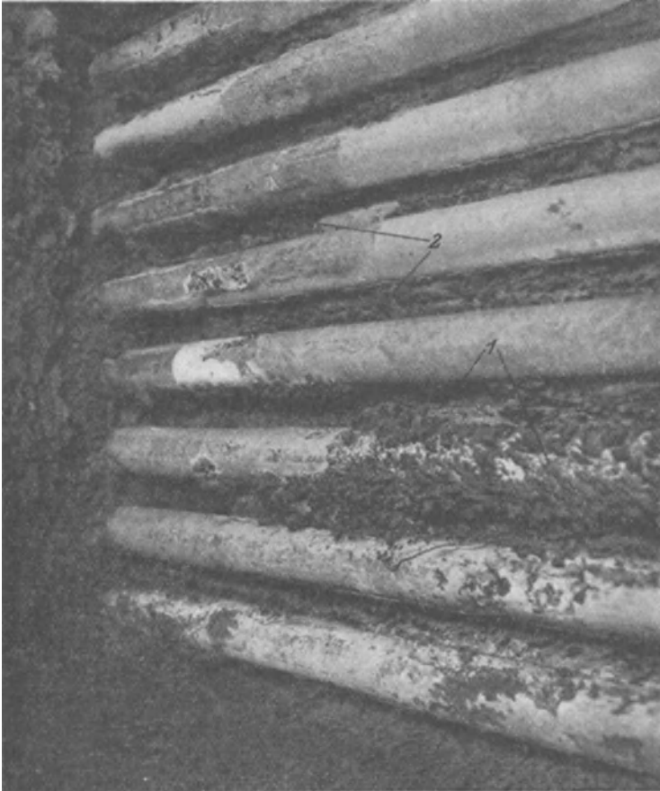
Abb. 61. Ansicht auf unterste Rohrreihe eines Wasserrohrkessels mit Flugaschen- und Schlackenansätzen infolge falsch bemessenem Feuerraum der Kohlenstaubfeuerung.
