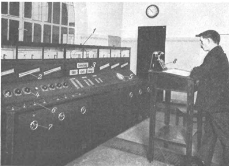
Abb. 68. Kommandozentrale für die einheitliche Regelung der Feuerführung in die drei getrennten Kesselhäuser der Chem. Fabrik Griesheim-Elektron in Bitterfeld. 1 = registrierende Manometer für die beiden Hauptdampfleitungen, daneben rechts und links 6 registrierende Zugmesser für 6 Hauptfische, 2 = Zugmesser nach Krell für 6 Hauptfische, 3 = Ankündigungssignale für Belastungszustand, 4 = Lichtsignale für Heizer (weiß = Schüren, rot = Abschlacken), 6 = Druckknopfschalter für akustische Achtungssignale, 7 = Handräder zur Fernsteuerung der Zugschieber, 8 = Fernsprecher.
