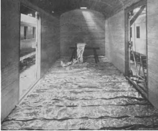
Abb. 37. Knitterfoliendämmschicht im Boden eines Kühlwagens.
