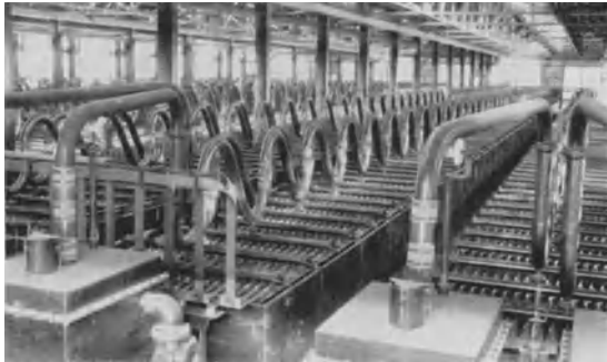
Abb. 12. Knowleszellenanlage in Nagoya (Japan).
