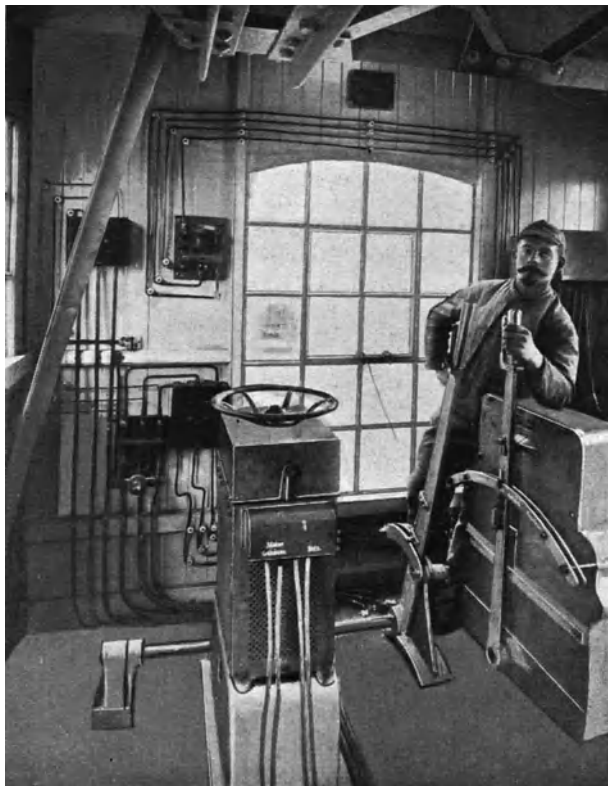
Fig. 168. Führerstand mit Anlasswiderständen eines Drehkranes, Drehstrom.
