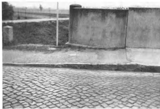
Abb. 114. Setzung der Brückenrampen (Beispiel).
