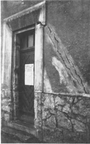
Abb. 73. Senkungsschaden im Bergbaugebiet (O.S.).
