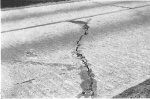
Abb. 93. Durch Frosthebung gerissene Betonstraße.
