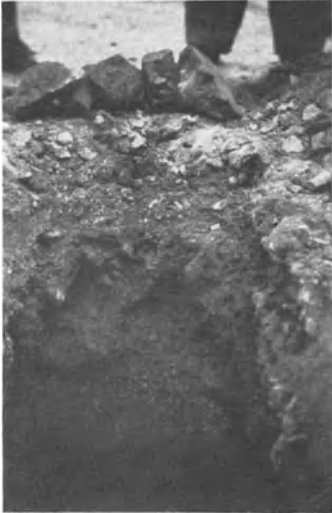
Abb. 109. Durch Ton verschmutzter Straßenunterbau.
