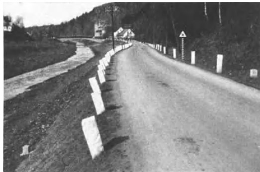
Abb. 103. Ausweichen der Straßenschulter und Böschung.
