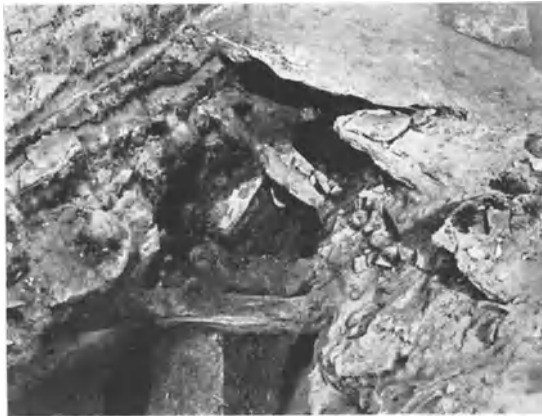
Abb. 126. Hohlräume unter dem Fundament.
