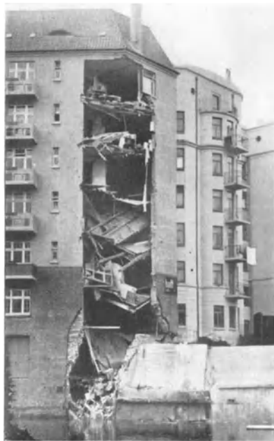
Abb. 149. Hauseinsturz in Hamburg.
