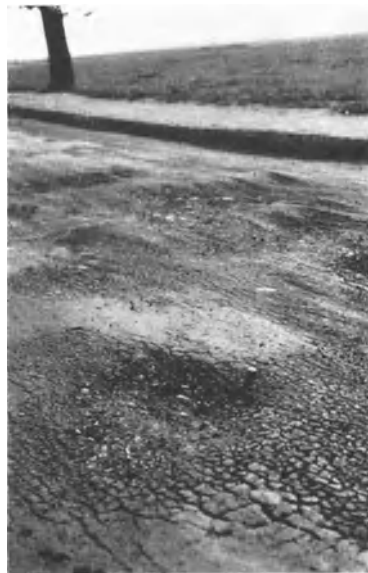
Abb. 96. Deckendurchbrüche nach dem Auftauen des Untergrundes.
