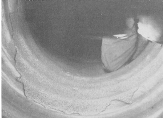
Abb. 238. Verschweißte Korrosionen an einem Kesselflamrohr.
