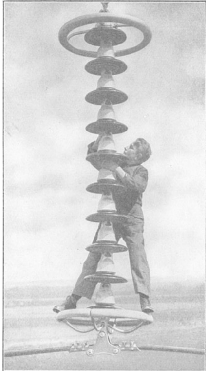
Abb. 110/8. Isolatorenkette einer 220-kV-Leitung mit Schutzringen (Hermisdorf).
