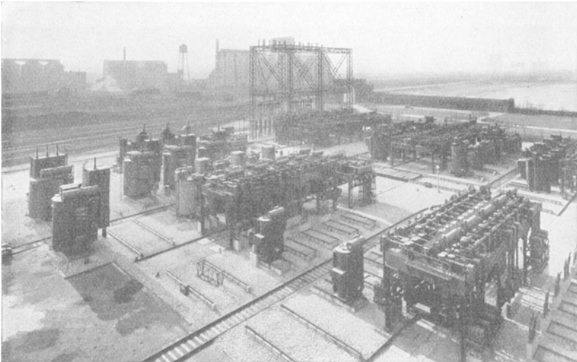
Abb. 99/10. Schaltanlage 20 kV eines amerikanischen Großkraftwerkes in kupfergekapselter Ausführung, mit Öl gefüllt.
