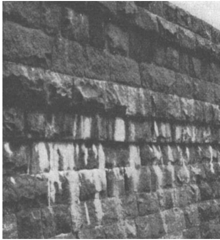
Abb. 632. Tyse. Ringedalsperre. Sinterungen an der Luftseite. (Verw.)
