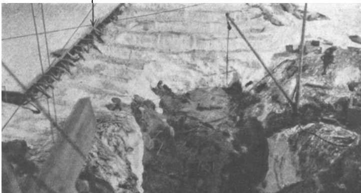
Abb. 933. Övre Breidalsvand. Baugrube 17. 6. 1924 inmitten weggeräumten Schnees; erst im August völlig schneefrei. Abb. 931—933. Höyanger-Baustellen im Winter. (Norsk Vandb. Kont.)
