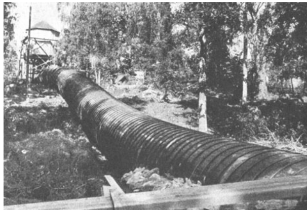
Abb. 776a u. b. Kleinwasserkraftanlage Viforsen. Holzdruckrohrleitung, d = 1,40 . (Verf.)
