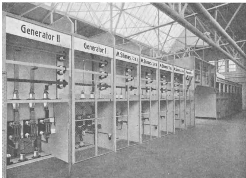
Fig. 639. Zellenanlagen für Sammelschienen und Apparate (S.S.W.).
