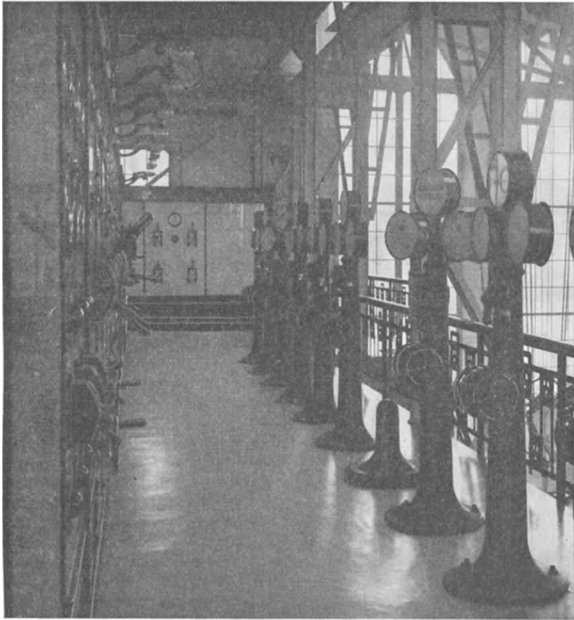
Fig. 619. Wandschalttafel und Schaltsäulen.
