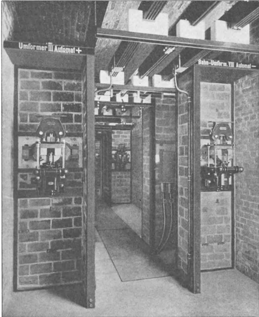
Fig. 625. Einbau der Sammelschienen und selbsttätigen Schalter im Keller eines Umformerwerkes.
