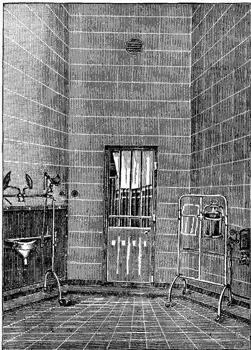
Рис. 4. Вентиляционная камера в операционной Боткинской б-цы. Наверху видна решетка электрического вентилятора. Через застекленную дверь видны отопительные радиаторы, подогревающие приточный воздух.
