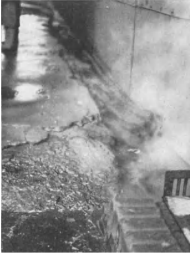
Abb. 186. Bild aus einem Kokslöschurm mit stark zerstörtem Mörtel. Boden und Ablaufrinne für das Löschwasser. (Schwefelsäureeinwirkung.)
