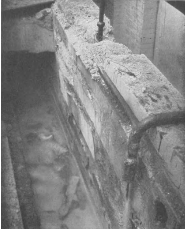
Abb. 212. Beton einer Abwasserrinne, durch Sulfate zerstört.
