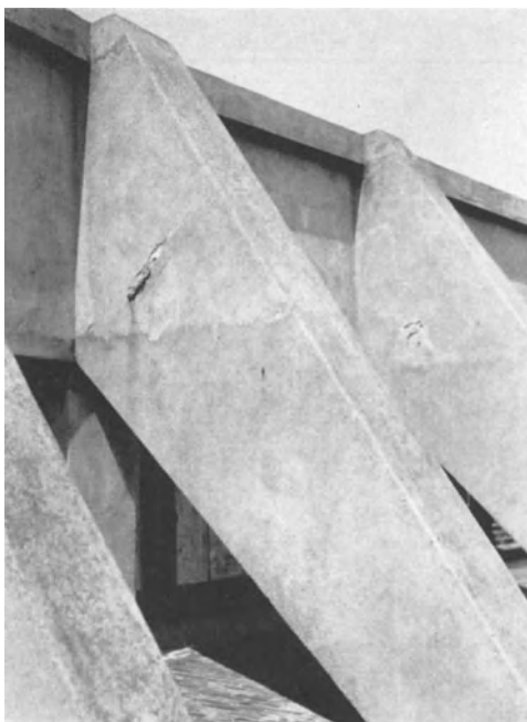
Abb. 229. Ufermauer am Meer. Die zu geringe Überdeckung der Eisen (1 cm) führt deren Rosten herbei.
