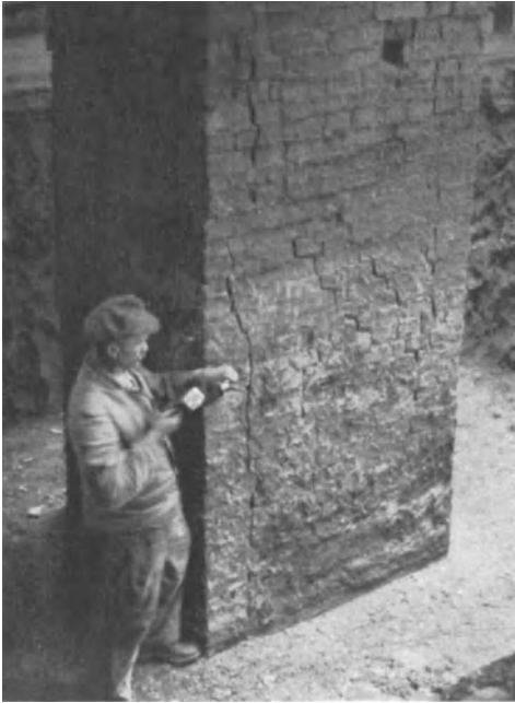
Abb. 183. Durch Einwirkung von Schwefelsäure zerstörter Pfeiler. (Aufn. Prof. Mohr, L'hafen.)
