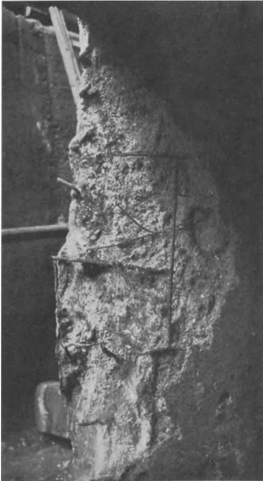
Abb. 188. Zerstörungen an einer Stützmauer durch stark verdünnte Salpetersäure. (Aufn. Prof. Mohr, L'hafen.)
