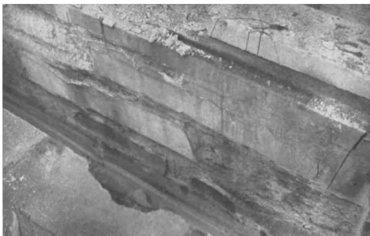
Abb. 213. Betonrinne, zerstört durch Ammonsalzwirkung.
