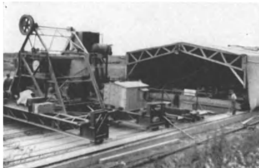
Abb. 111. Baustelle zur Herstellung von Betonstraßen: links die Mischmaschine, in der Mitte der Verteilerwagen, rechts das Zelt, in dem die Maschinen arbeiten.
