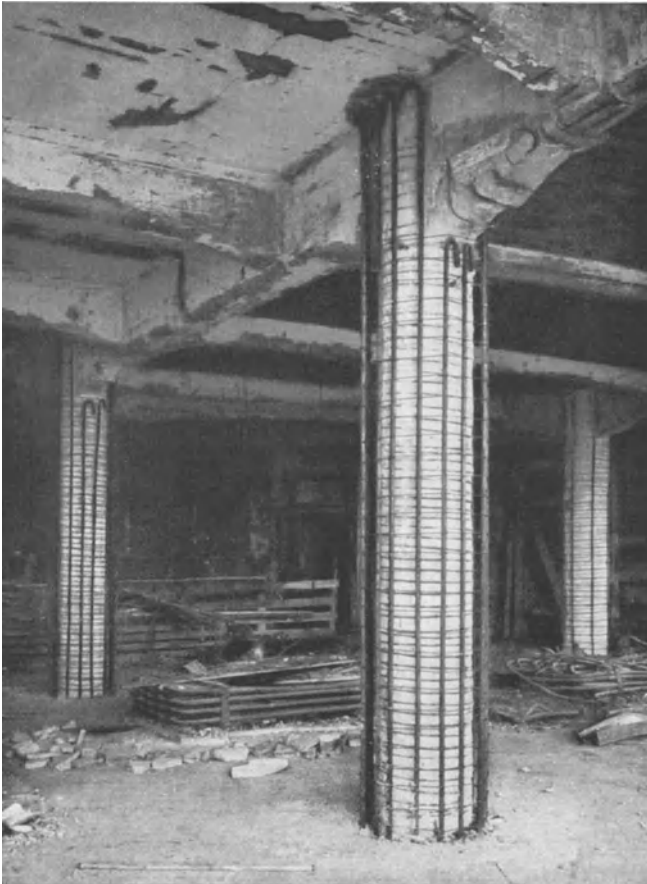
Abb. 249. Zerstörung durch Feuer in der Sarottifabrik. Die Säulen sind wieder mit Bewehrungs-eisen zur Aufnahme des Spritzbetons umgeben. (Moser-Kraftbau.)
