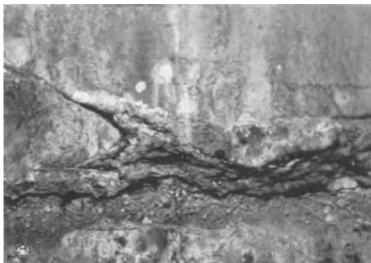
Abb. 228. Arbeitsfugen einer Ufermauer. Der Beginn der Zerstörung durch das Meerwasser zeigt sich an den ursprünglichen Schüttfugen.
