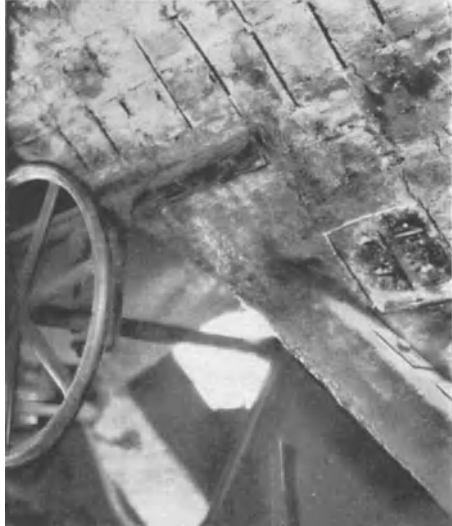
Abb. 235. Siloboden eines Kohlenbunkers, angegriffen durch schwefelsäurehaltiges Abwasser, das sich aus dem Schwefel der Kohle gebildet hatte. (Zu geringe Überdeckung der Eisen.)
