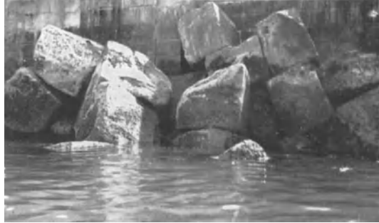
Abb. 226. Wellenbrecherblöcke an einer Ufermauer in Zerstörung begriffen durch Meerwasserwirkung. Charakteristisch sind die abgerundeten Kanten.
