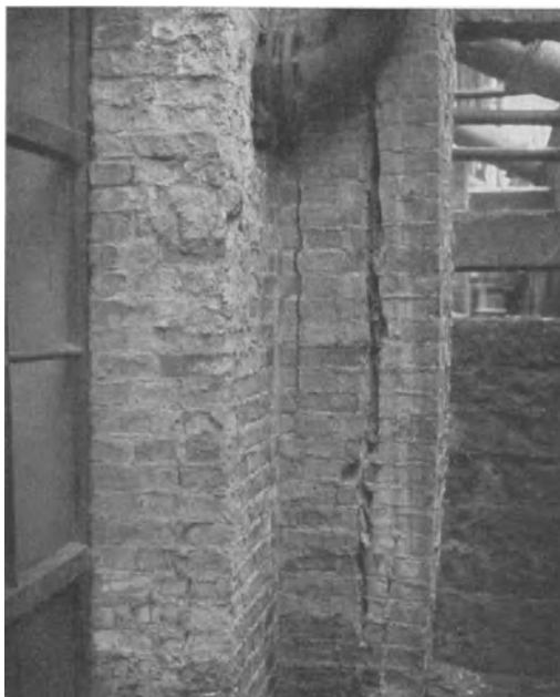
Abb. 184. Durch Bildung von Sulfat zerstörter Pfeiler aus Klinker in Zementmörtel. (Aufn. Prof. Mohr u. Goebel.)
