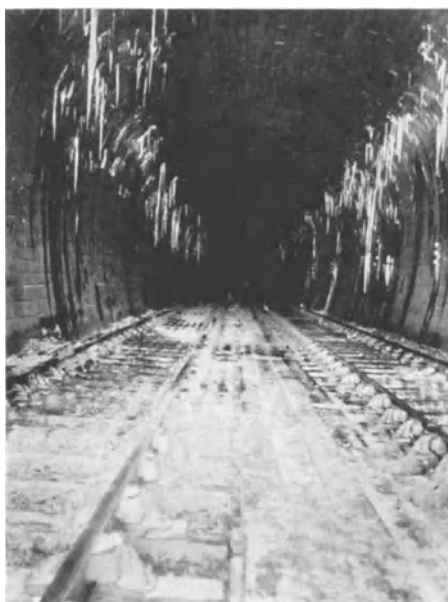
Abb. 185. Tunnel aus Bruchsteinmauerwerk, wo der Mörtel durch die Lokomotivgase zerstört war: Das Bild ist im Winter aufgenommen. Die Eiszapfen zeigen deutlich an, daß da, wo die Lokomotivgase gegen die Decke geblasen wurden, der Tunnel infolge der Zerstörung undicht geworden war.
