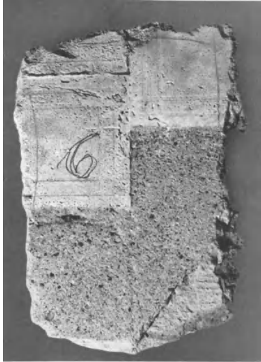
Abb. 182. Einwirkung von Chlorkalk und Sulfat auf die Wand eines Holländers bei der Papierfabrikation. Der Holländer war zunächst durch Platten im Innern geschützt, ein Teil derselben fiel ab. Nach wenigen Tagen war die Wand schon einige Millimeter tief aufgelöst. Die Platten mit der Zahl 6 sind erst nach Entnahme des Betonstücks aus dem Holländer abgesprengt, die starke Schutzwirkung der Platte ist ersichtlich.
