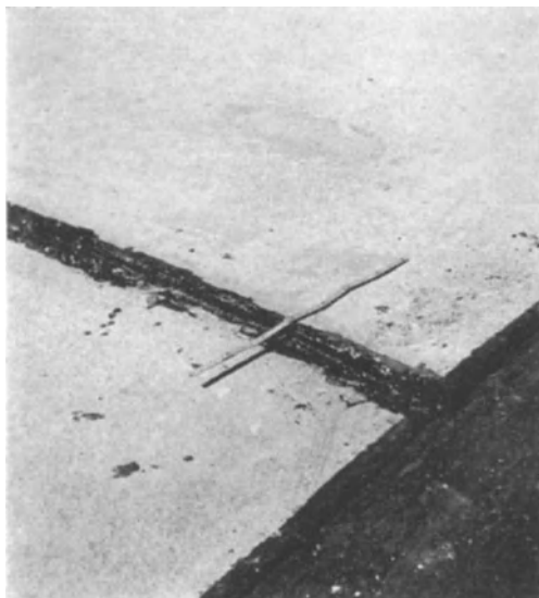
Abb. 115. Absenkung einer Platte gegen die andere durch Absenken des Untergrundes.
