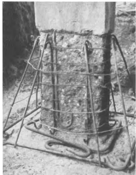
Abb. 260. Umschnürung des nach Abb. 259 beschädigten Pfeilers mit Bewehrungsseisen.
