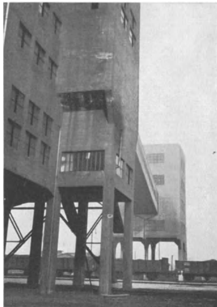
Abb. 236. Kohlensilo, bei welchem die beginnende Zerstörung durch die Schwefelsäure aus der Kohle von außen bereits zu erkennen ist (weiße Ausschläge, undichter Beton).
