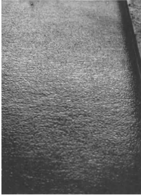
Abb. 110. Oberflächenzerstörung einer Betonstraßendecke, die vom Platzregen getroffen wurde, bevor der Zement abgebunden hatte.
