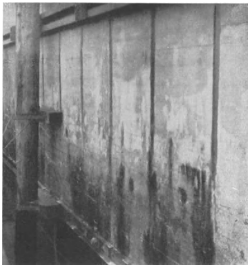
Abb. 220. Hafenumauer bei Ebbe, beschädigt durch Gipswasser, das sich aus Gipsverunreinigungen aus den zum Auffüllen verwendeten Erdmassen gebildet hat.
