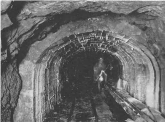
Abb. 192. Tunnel unter einem moorigen Wald. Die Stalaktiten sind gebildet durch das kohlen-säurehaltige Wasser aus dem Kalk des Betons. Sie traten schon nach wenigen Wochen auf, ehe der Tunnel überhaupt benutzt wurde.
