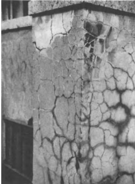
Abb. 125. Zu fett hergestellter Zementputz durch Schwindrisse zerstört.
