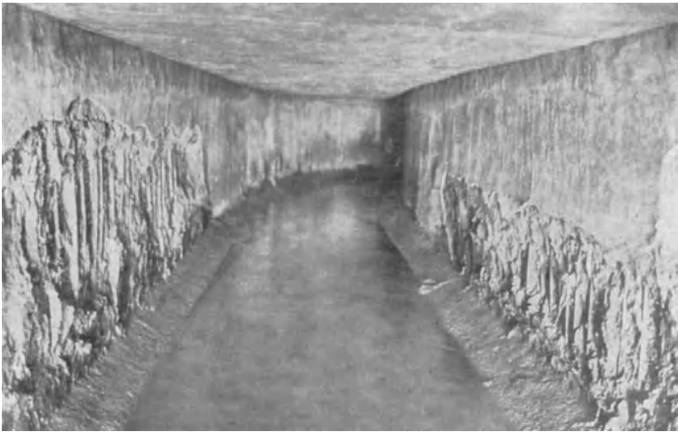
Abb. 190. Betonkanal, beschädigt durch Sulfatbildung im Beton.
