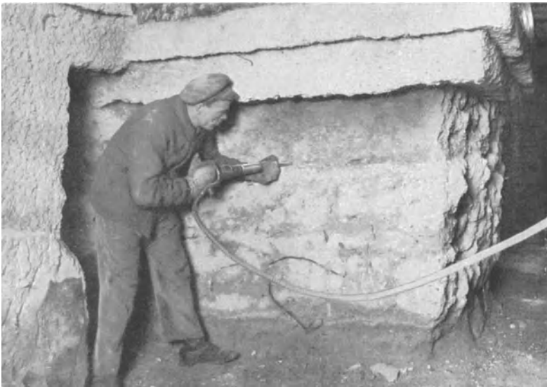
Abb. 256. Entfernung von durch Sulfatwirkung beschädigtem Beton durch Lufthammer bis tief in den Kern vor Aufbringung des neuen Betons. (Aufn. Goebel, L'hafen.)
