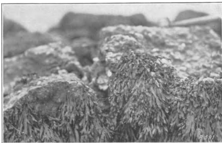
Abb. 224. Mit Tang bewachsenen, durch Meerwasser zerstörten Beton auf Helgoland. Die starke Zerstörung zeigt, daß die Tangbewachung den Beton nicht schützt, daß er im Gegenteil unter dem Tang besonders stark zerstört wird.
