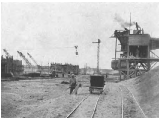
Abb. 88. Einbringung des Betons mit Drahtseilbahn in die Schaltung von der stationär hergestellten Mischanlage.
