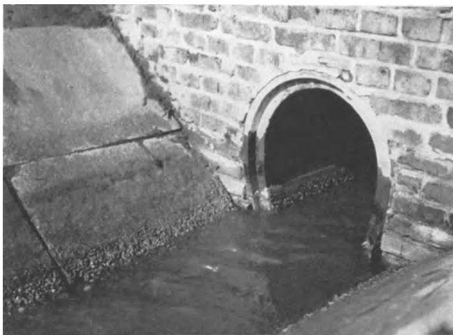
Abb. 231. Bachbett-Befestigungsplatten und Betonrohr, angegriffen durch die Abwässer einer Beizerei, die verbotenerweise dem korrigierten Bach zugeführt wurden. (Herauslösen des Zementes aus der Oberfläche.)
