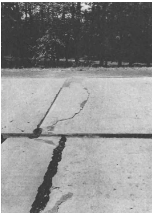
Abb. 118. Infolge der zu engen oder unreinen Fugen ist bei Herstellung des Betons bei kühlem Wetter und Ausdehnung im Sommer die Platte gestaucht und die Oberfläche des Betons gesprengt.
