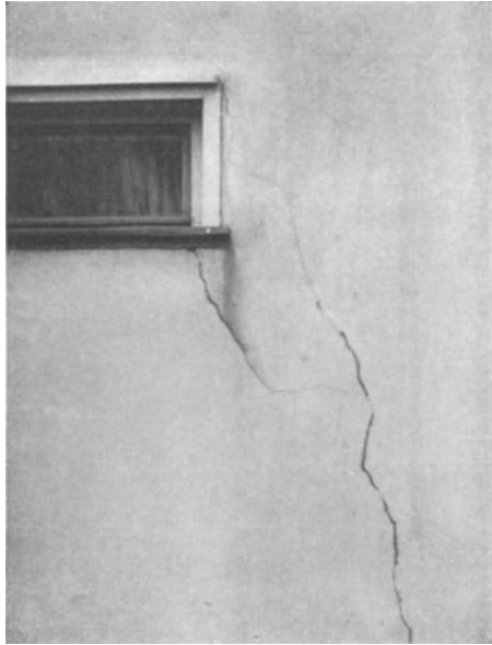
Abb. 124. Risse in einem Hausputz durch falsch angebrachtes Fenster: Das Holzwerk des Fensters ist eingeputzt und ragt über den Putz hervor, beim Arbeiten durch Wärme und Wasser zersprengt das Holz den Putz.
