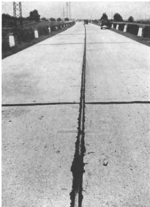
Abb. 116. Erweiterung der Mittelfugen durch Wandern der Platten nach der Seite auf einen frisch geschütteten Damm. Durch nachträgliche Verdübelung hat man versucht, die Platte zu halten, man sieht deutlich die Flickstellen.
