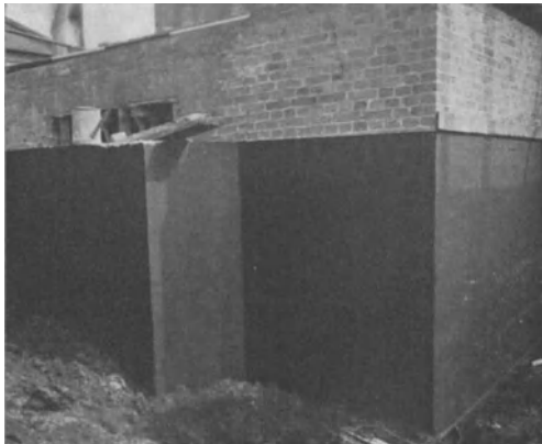
Abb. 238. Durch Schutzanstrich ordnungsgemäß geschütztes Bauwerk vor Wiederanbringung der Erde. Eine Umstämpfung mit Lehm ist häufig zweckmäßig.
