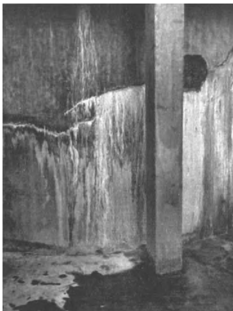
Abb. 195. Außenwand eines Holländers (vgl. Abb. 182), hergestellt aus porösem Beton: Sowohl die Plattenverkleidung im Innern als auch der feine Putz von außen vermochten den Durchtritt des Wassers, das in großen Mengen den Kalk aus dem Beton herauslöste, nicht aufzuhalten, die Holländer mußten abgerissen werden.
