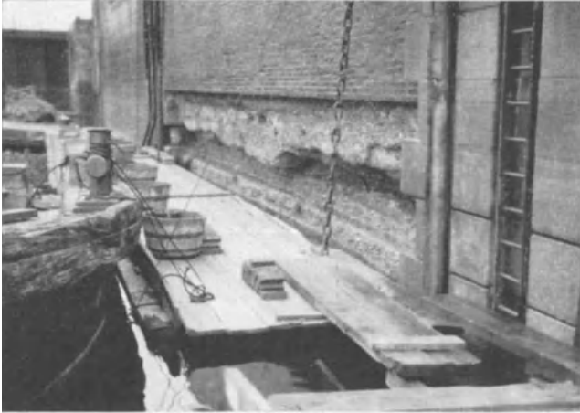
Abb. 133. Entmischter poröser Beton aus Portlandzement, Traß und Kalk, der hinter Klinkerverblendung zerstört wurde.
