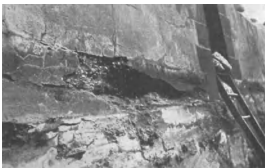
Abb. 234. Winkelstützmauer aus Eisenbeton, stark zerstört. Die Eiseneinlagen waren stark verrostet und der Putz völlig zerrissen.
