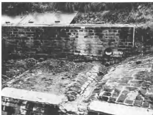
Abb. 207. Durch sulfathaltiges Wasser aus einer Schlackenhalden zerstörtes Backsteinmauerwerk. Das Bild zeigt deutlich die Treiberscheinungen und die Tatsache, daß Backsteinmauerwerk nicht beständiger ist als Beton, sondern häufig schneller zugrunde geht.
