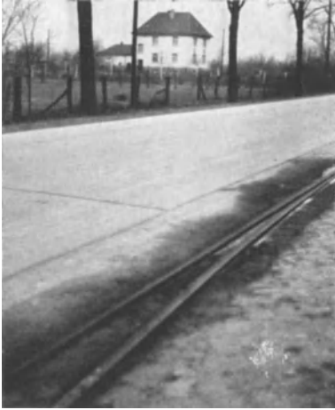
Abb. 112. Oberflächenzerstörung einer Betonfahrbahn um eine Weiche herum, hervorgerufen durch Kochsalz, mit dem die Weiche im Winter beweglich gehalten wurde.
