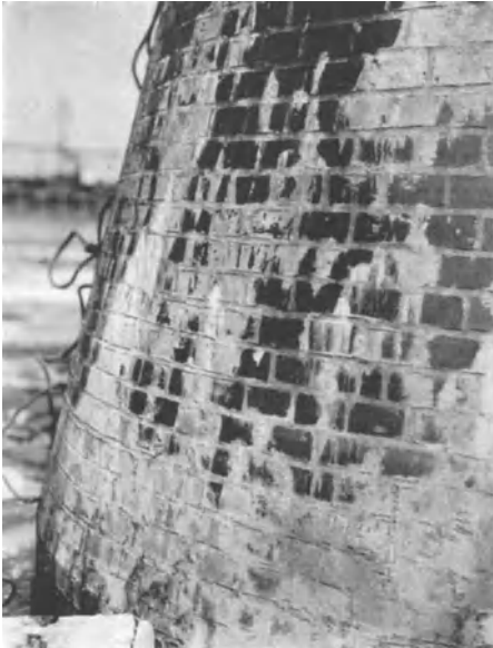
Abb. 193. Betonpfeiler, verblendet mit Mauerwerk, durch welchen kohlensäurehaltiges und sulfathaltiges Wasser gepreßt wurde. Der weiße Belag ist kohlen-saurer Kalk aus dem Beton.
