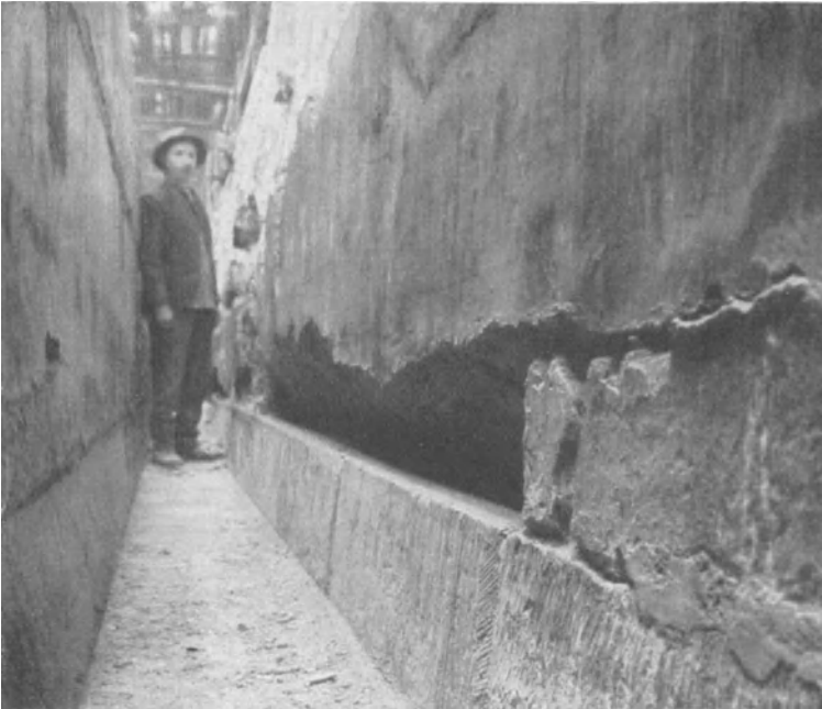
Abb. 211. Betonwand über einer Abwasserrinne aus Sandstein, durch ammoniumsulfathaltiges Wasser zerstört.
