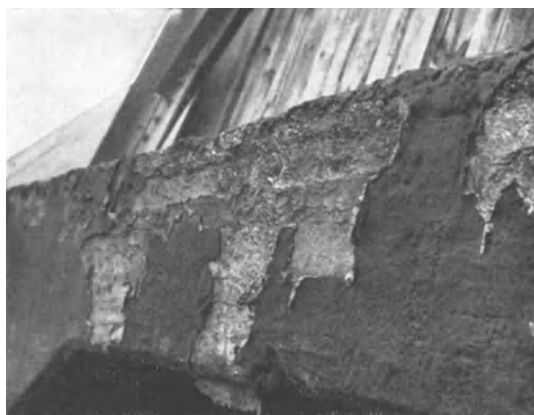
Abb. 240. Auf ungünstigem Untergrund aufgebrachte Spachtelmasse bei einem Kühlturm: die dick aufgebrachte Schutzmasse ist infolge Sprödigkeit der obersten Betonschicht abgefallen.
