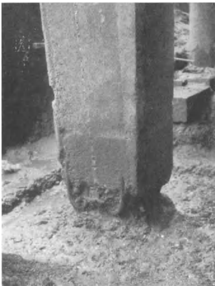
Abb. 259. Durch frühzeitige Überflutung mit salzhaltigem Grundwasser beschädigter Betonpfeiler. Grün, Beton. 2. Aufl.
