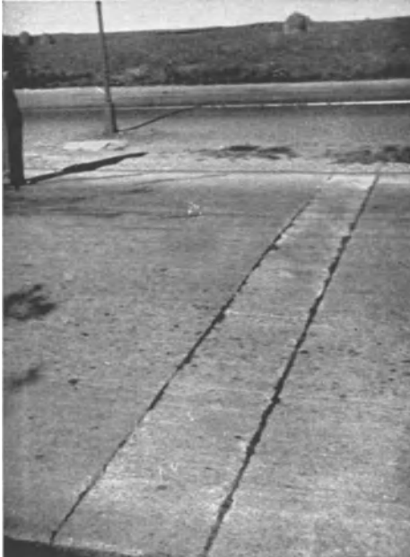
Abb. 119. Betonstraße mit Knirschen-Fugen, gebaut vor 8 Jahren: Zuerst wurde die Platte rechts und links betoniert und nach deren Erhärtung der schmale Streifen eingefügt.
