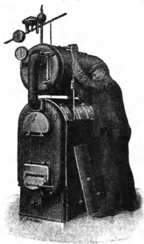
Abb. 163. Reinigung der Rauchkanäle des Strebelskessels. Auf dem Dampfessel befindet sich der Verbrennungsregler.
